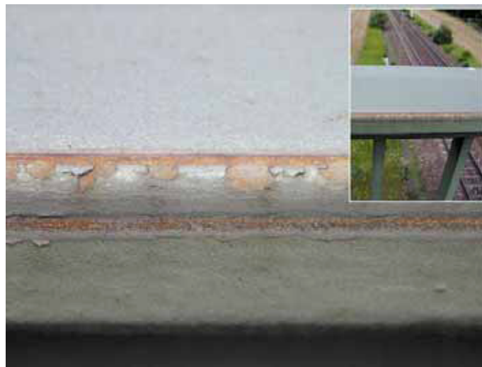
Bild 1: Randkorrosion an einem Brückengeländer
