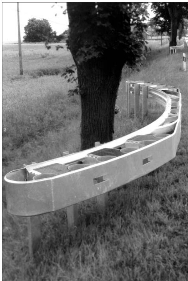
Bild 50: Spezielle Schutzeinrichtung vor Bäumen
