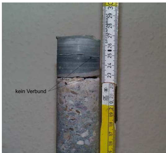
Bild 33: Block 136.2, Messpunkt 732, Bohrkern von der Fehlstelle (Detailaufnahme)
