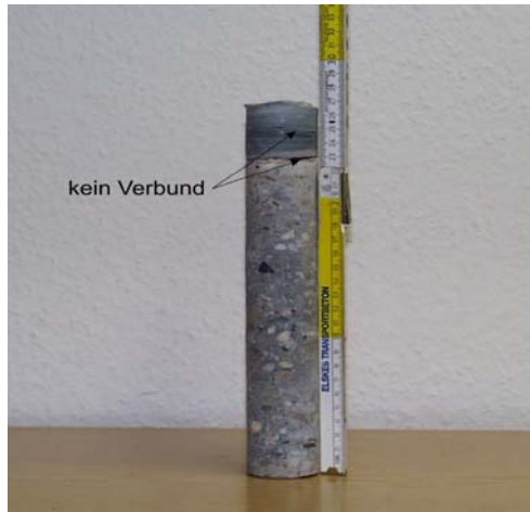
Bild 32: Block 136.2, Messpunkt 732, Bohrkern von der Fehlstelle
