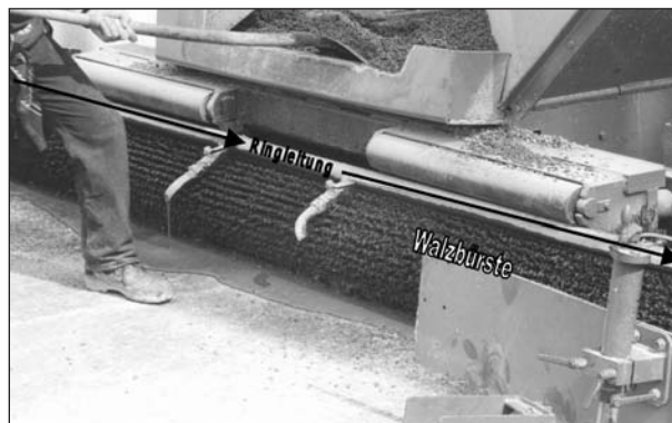
Bild 6.2: Ringleitung zur Ausbringung der Haftbrücke
