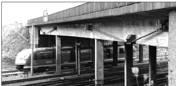
Bild 11: Brücke im Rostocker Hafen, Verstärkung eines Plattenbalkens durch externe Vorspannung (ALEX, 2011)
