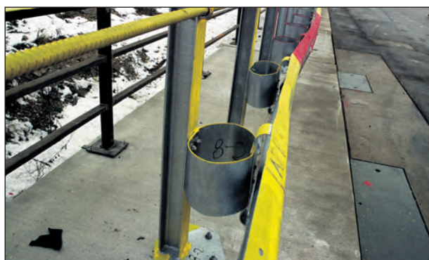
Bild 40: System E: Kontaktstrecke nach Prüfung TB 11 mit Systemschäden
