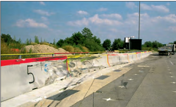
Bild 22: System A: Kontaktstrecke nach Prüfung TB 81 mit Systemschäden
