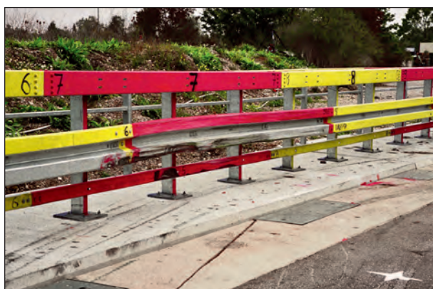
Bild 25: System B: Kontaktstrecke nach Prüfung TB 11 mit Systemschäden
