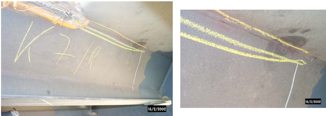
Bild 2: Typische Risse im Anschlussbereich Deckblech-Längsrippe an der Rheinbrücke Leverkusen © R.Lange GmbH, Moers
