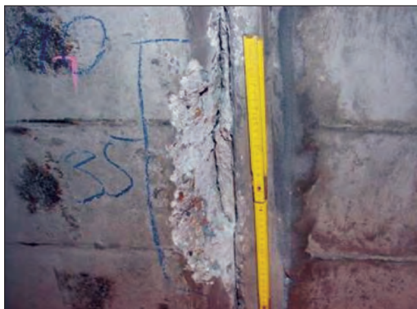
Bild 46: Abplatzung im Bereich der Blockfuge (Südröhre/neu)
