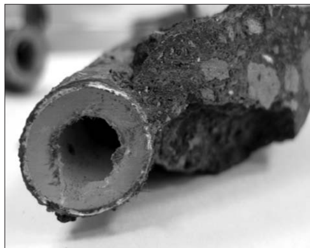
Bild 120: Querschnitt des ausgebauten Rohrstückes
