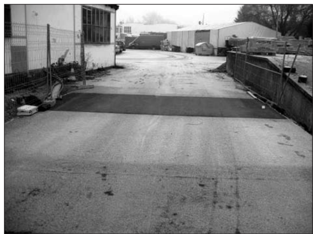
Bild 98: Foto von der Testbrücke, vom 20.12.2007 – Vergleich temperiertes Modul (schneefrei), untemperiertes Modul (Mitte), Straße auf Erdreich (Vordergrund)
