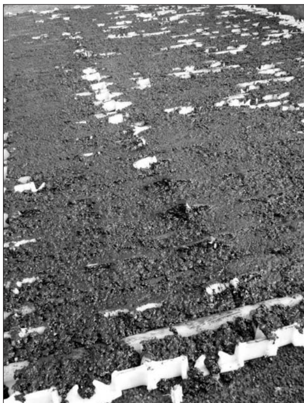
Bild 85: Verformung der Matten
