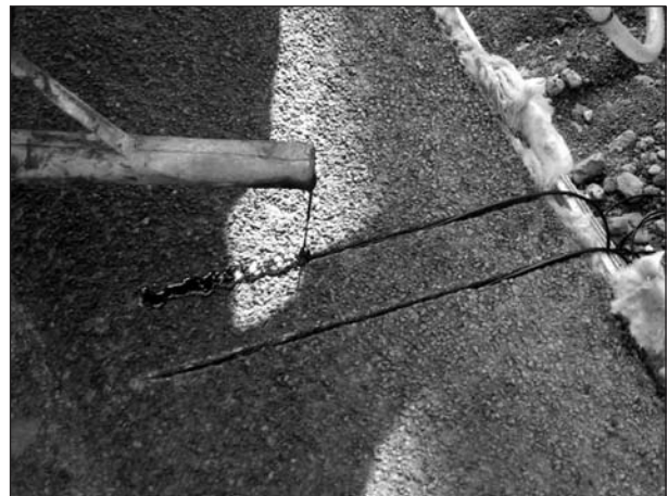
Bild 92: Oberflächen-Temperaturfühler über und zwischen den Rohren
