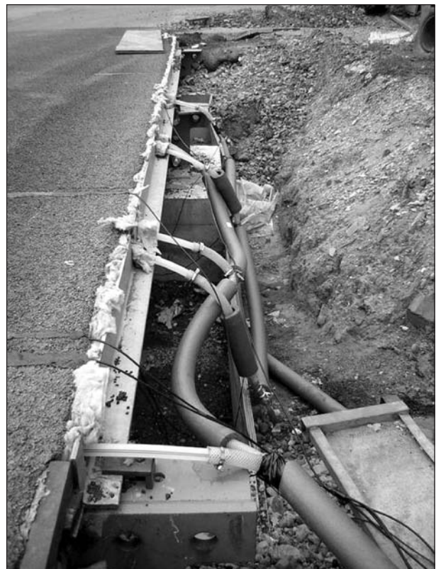
Bild 93: Fertige Installation der Messtechnik und des Wasserkreislaufes
