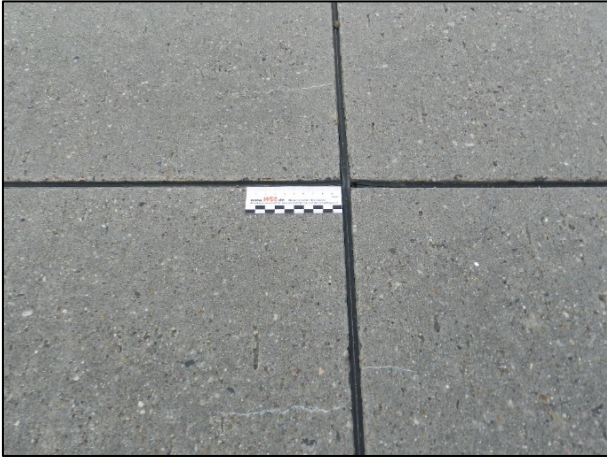
Bild 3-2: Beginn von Eckabbrüchen ohne Anzeichen einer Dunkelverfärbung
