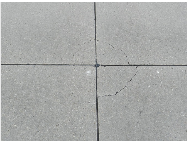
Bild 3-3: Deutlich sichtbare Eckabbrüche ohne Anzeichen einer Dunkelverfärbung
