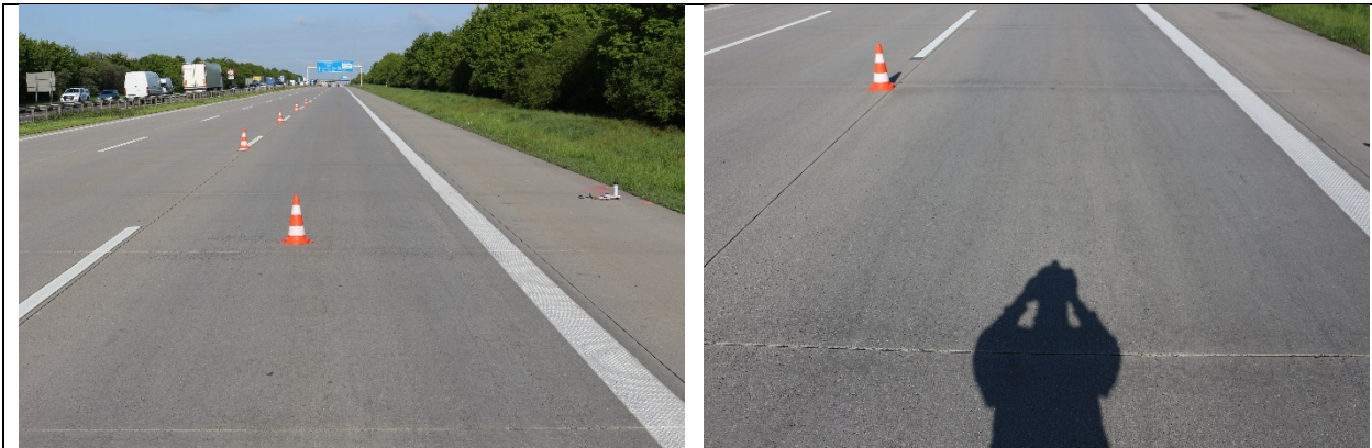
Bild 5-37: Übersichtsaufnahme vom untersuchten Abschnitt zwischen km 91+000 und km 91+055 (links) und Detail bei Platten-Nr. 1388 (rechts) mit Rissbildungen in den Querfugen und Rüttelgassen
