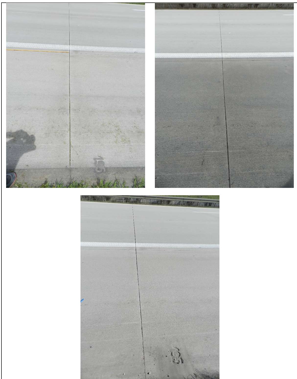
Bild A - 38: Zustand der Fahrbahndecke, Platten-Nr. 195, am 31.07.2017 (oben links), am 14.12.2017 (oben rechts) und am 09.04.2018 (unten)
