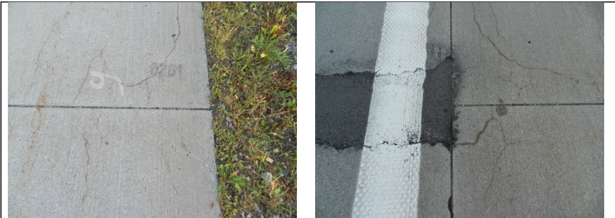
Bild A - 7: Querfuge und Fugenkreuz zwischen Plattenreihe 0260 und 0261 (linkes Bild: SS, rechtes Bild: SS – HF)
