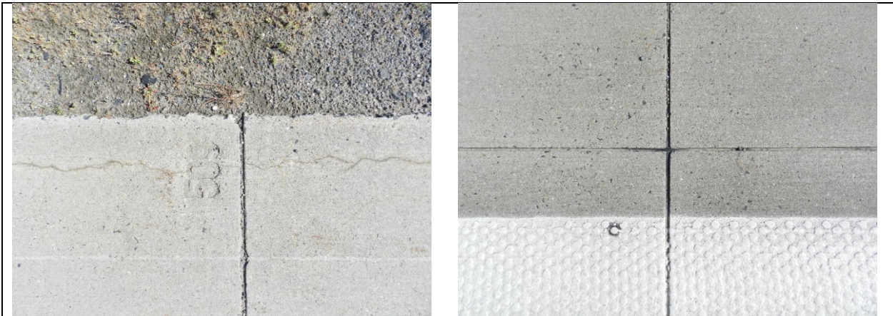
Bild A - 21: Querfuge und Fugenkreuz zwischen Plattenreihe 0508 und 0509 (linkes Bild: SS, rechtes Bild: SS – HF)
