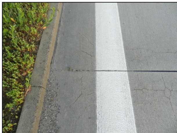
Bild A - 6: Querfuge zwischen Plattenreihe 0259 und 0260 (2.ÜFS)
