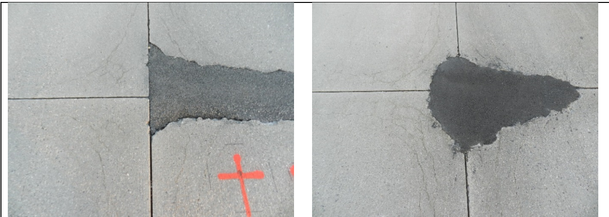
Bild A - 8: Fugenkreuze zwischen Plattenreihe 0260 und 0261 (linkes Bild: HF – 1.ÜFS, rechtes Bild: 1.ÜFS – 2.ÜFS)
