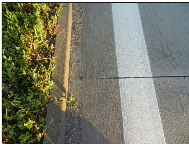
Bild A - 3: Querfuge zwischen Plattenreihe 0258 und 0259 (2.ÜFS)
