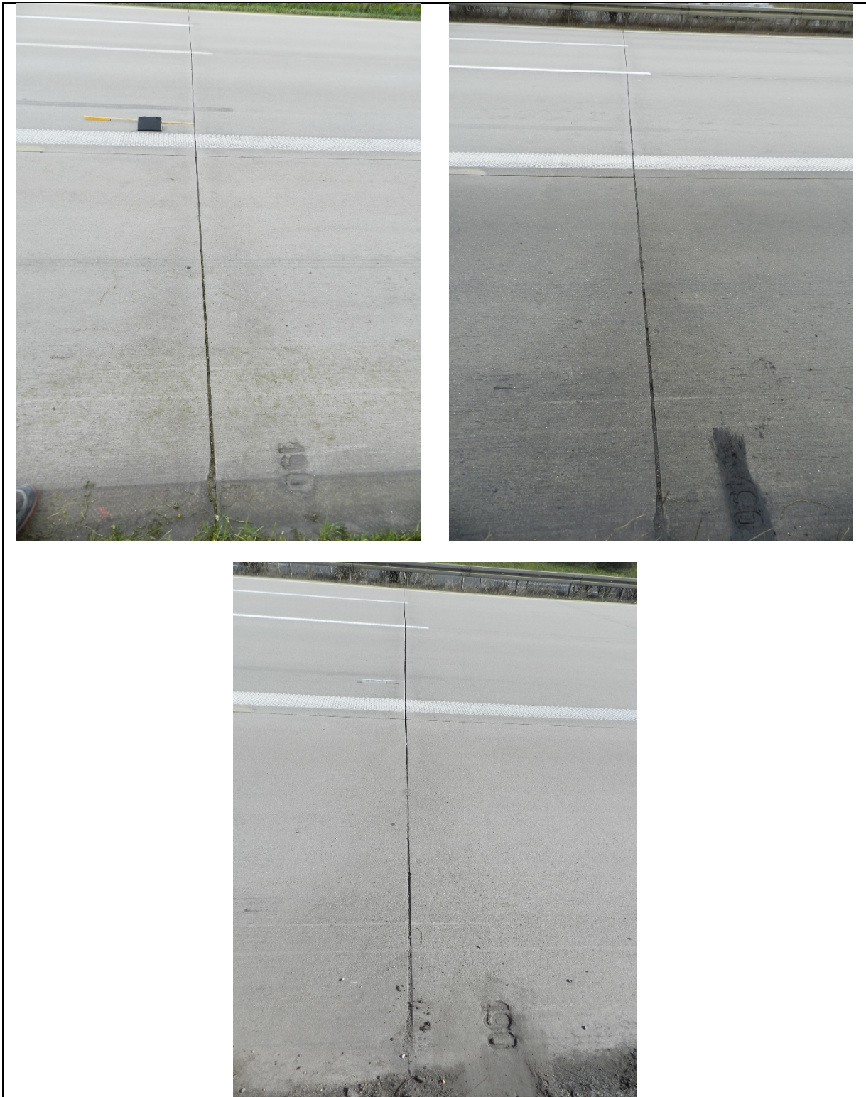
Bild A - 33: Zustand der Fahrbahndecke, Platten-Nr. 190, am 31.07.2017 (oben links), am 14.12.2017 (oben rechts) und am 09.04.2018 (unten)
