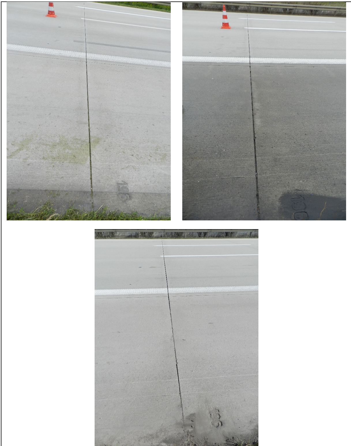
Bild A - 39: Zustand der Fahrbahndecke, Platten-Nr. 196, am 31.07.2017 (oben links), am 14.12.2017 (oben rechts) und am 09.04.2018 (unten)
