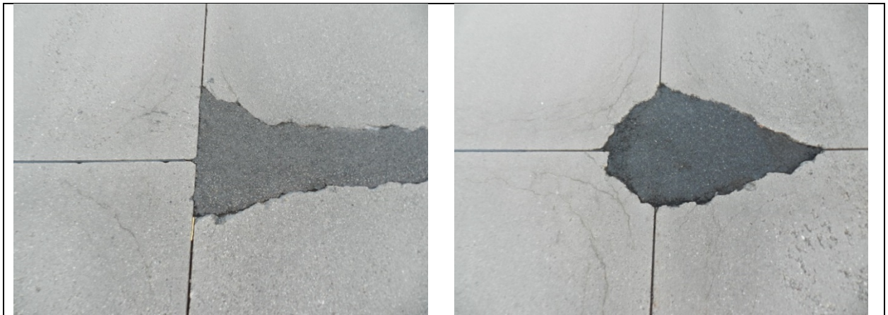
Bild A - 5: Fugenkreuze zwischen Plattenreihe 0259 und 0260 (linkes Bild: HF – 1.ÜFS, rechtes Bild: 1.ÜFS – 2.ÜFS)
