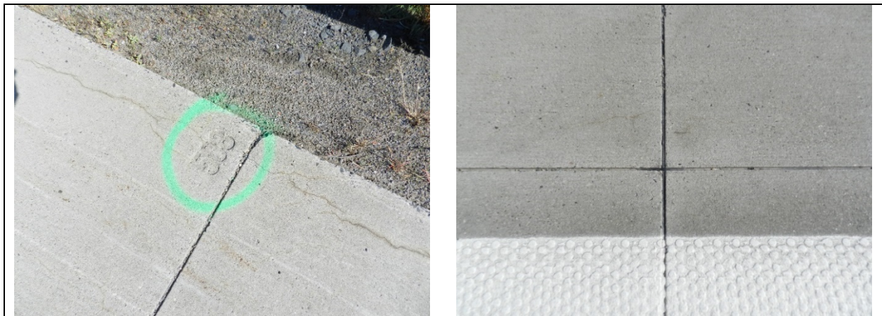
Bild A - 18: Querfuge und Fugenkreuz zwischen Plattenreihe 0507 und 0508 (linkes Bild: SS, rechtes Bild: SS – HF)
