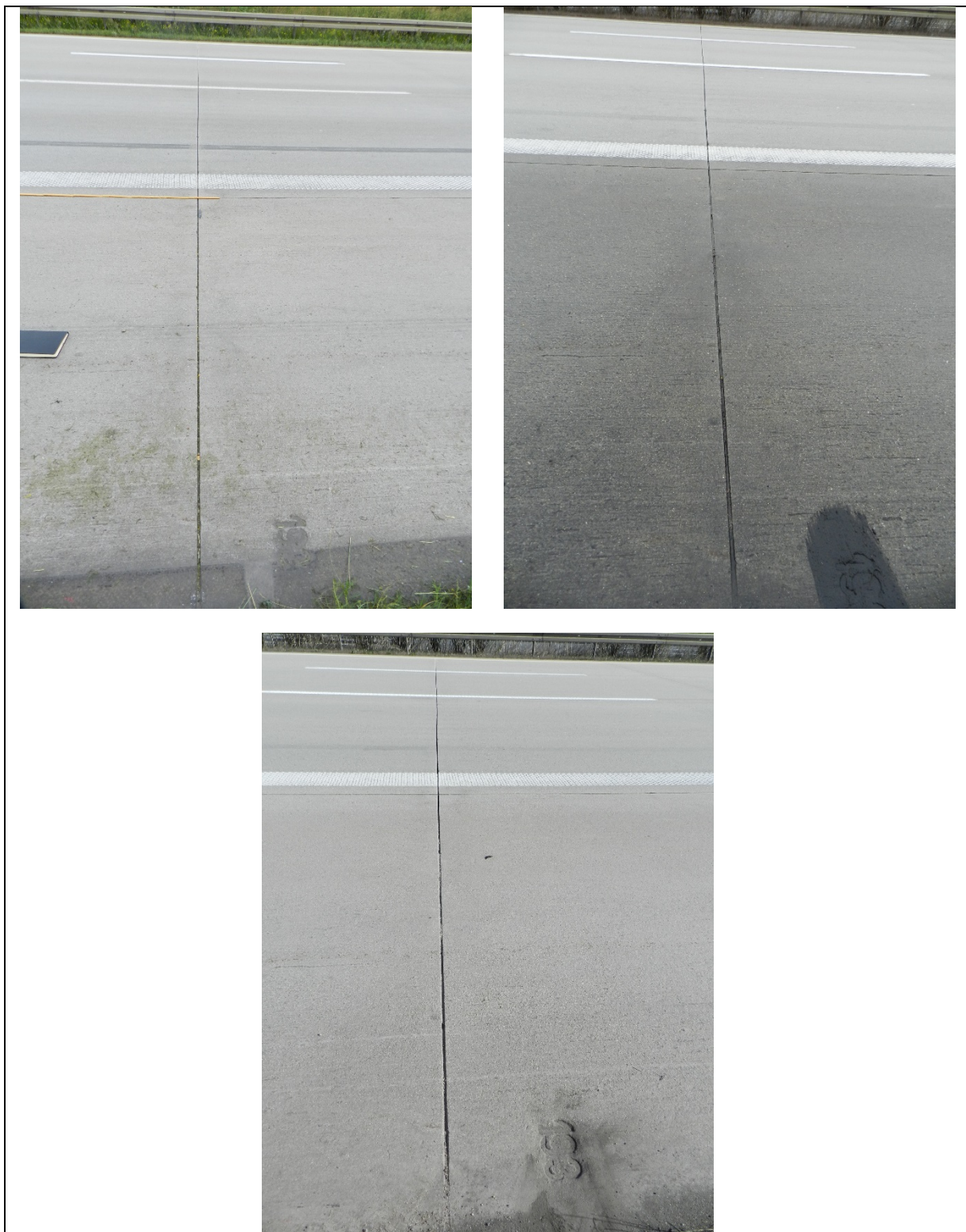
Bild A - 36: Zustand der Fahrbahndecke, Platten-Nr. 193, am 31.07.2017 (oben links), am 14.12.2017 (oben rechts) und am 09.04.2018 (unten)
