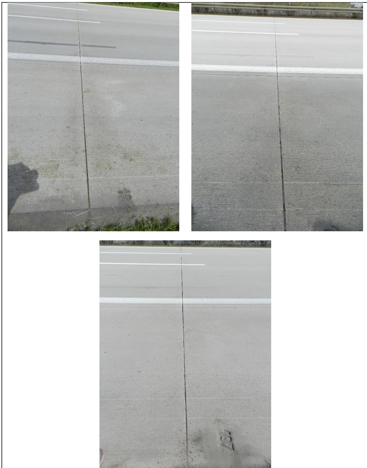
Bild A - 40: Zustand der Fahrbahndecke, Platten-Nr. 197, am 31.07.2017 (oben links), am 14.12.2017 (oben rechts) und am 09.04.2018 (unten)
