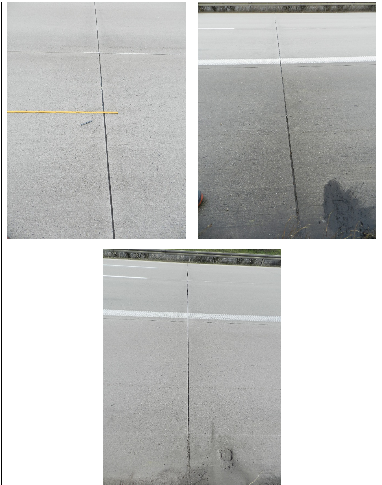
Bild A - 37: Zustand der Fahrbahndecke, Platten-Nr. 194, am 31.07.2017 (oben links), am 14.12.2017 (oben rechts) und am 09.04.2018 (unten)
