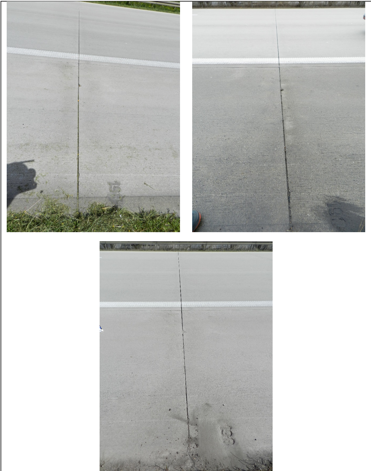
Bild A - 41: Zustand der Fahrbahndecke, Platten-Nr. 198, am 31.07.2017 (oben links), am 14.12.2017 (oben rechts) und am 09.04.2018 (unten)
