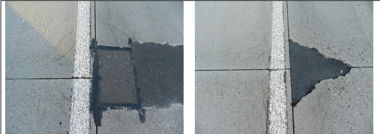
Bild A - 2: Fugenkreuze zwischen Plattenreihe 0258 und 0259 (linkes Bild: HF – 1.ÜFS, rechtes Bild: 1.ÜFS – 2.ÜFS)
