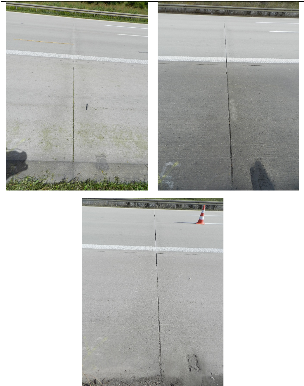
Bild A - 35: Zustand der Fahrbahndecke, Platten-Nr. 192, am 31.07.2017 (oben links), am 14.12.2017 (oben rechts) und am 09.04.2018 (unten)
