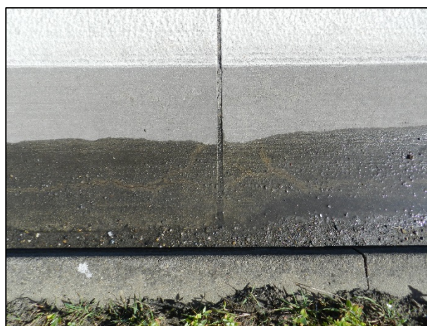
Bild A - 20: Querfuge zwischen Plattenreihe 0507 und 0508 (2.ÜFS)
