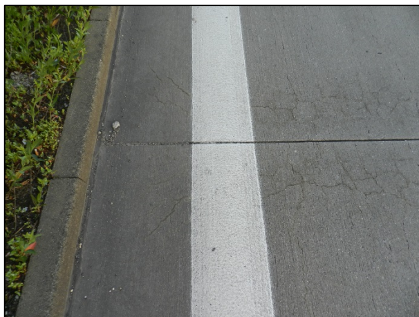
Bild A - 9: Querfuge zwischen Plattenreihe 0260 und 0261 (2.ÜFS)
