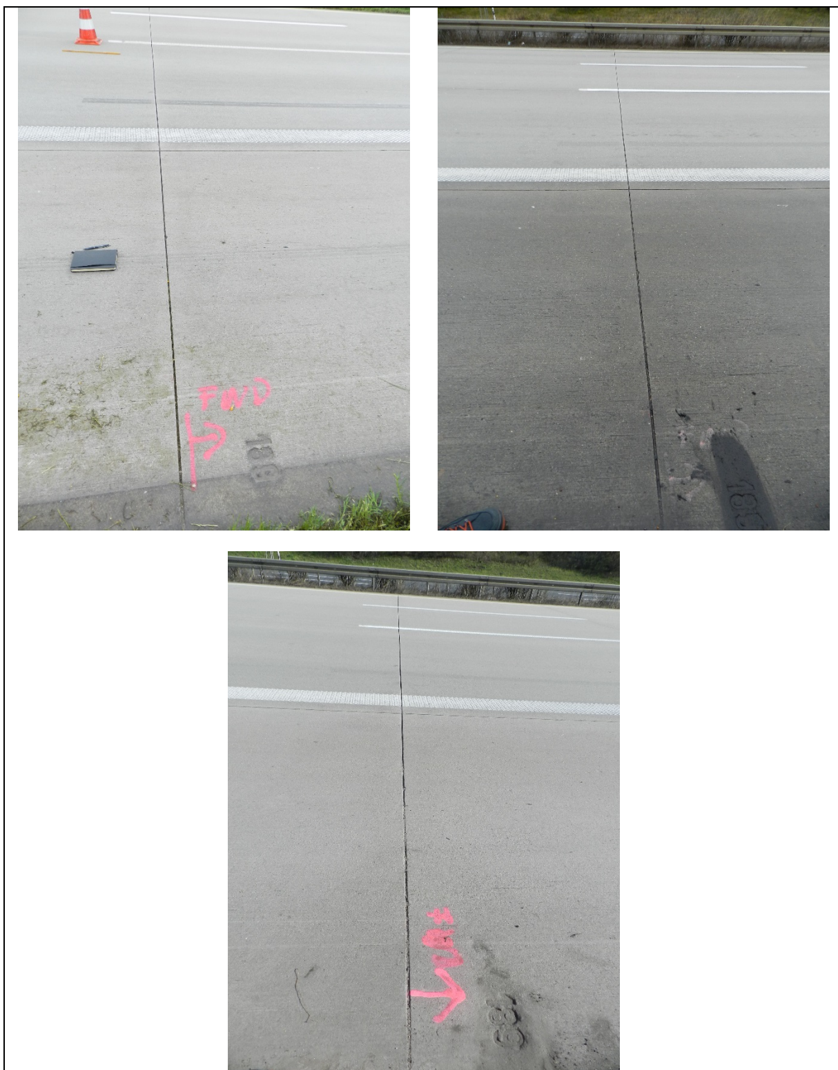
Bild A - 32: Zustand der Fahrbahndecke, Platten-Nr. 189, am 31.07.2017 (oben links), am 14.12.2017 (oben rechts) und am 09.04.2018 (unten)
