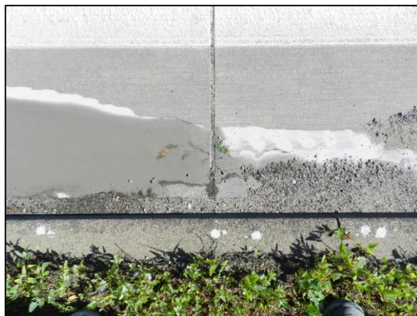
Bild A - 23: Querfuge zwischen Plattenreihe 0508 und 0509 (2.ÜFS)
