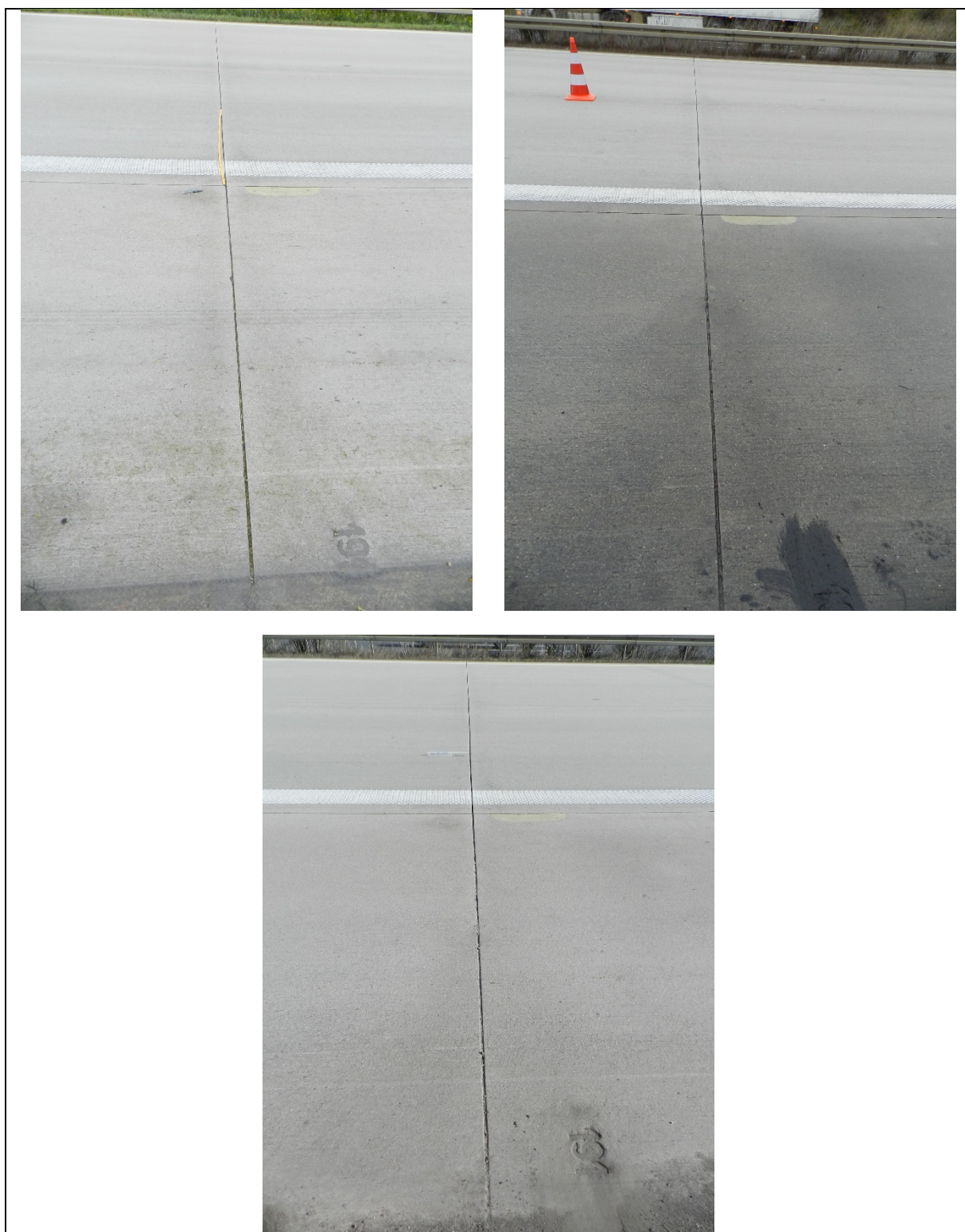
Bild A - 34: Zustand der Fahrbahndecke, Platten-Nr. 191, am 31.07.2017 (oben links), am 14.12.2017 (oben rechts) und am 09.04.2018 (unten)
