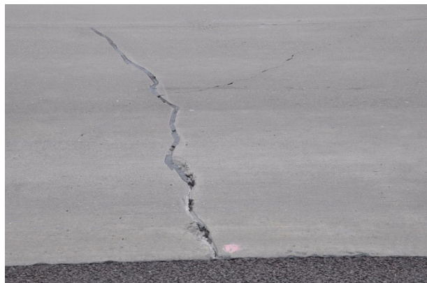
Bild 5.3: Durchgehender Querriss mit Ausbrüchen und Schrägriss
