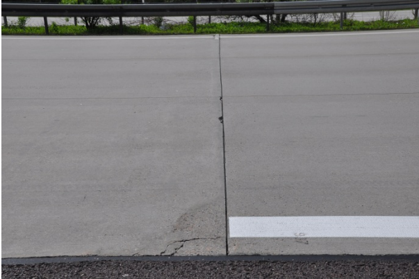
Bild 5.4: Kantenschäden und Eckabbruch
