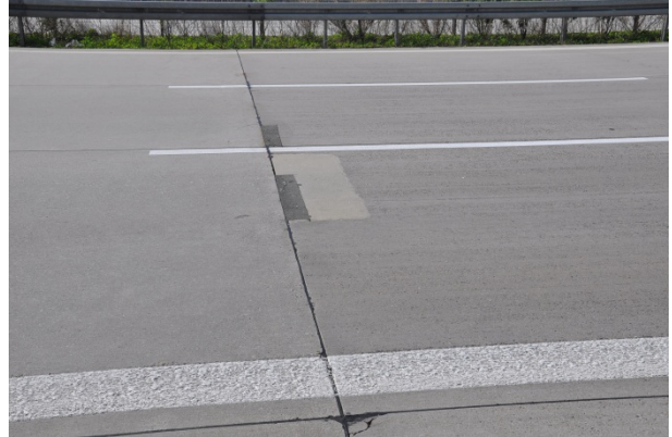
Bild 5.7: Tagesansatz mit Kantenschäden und Eckabbruch
