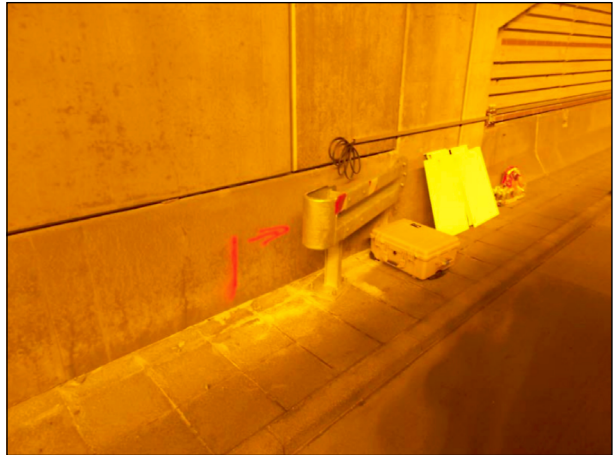
Bild 144: Schutzvorrichtung vor dem Messcontainer
