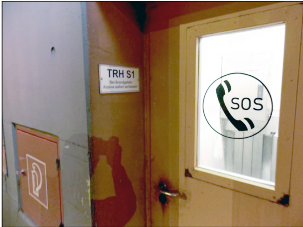
Bild 141: Exemplarisch: Die Versorgung der Messstationen mit Strom erfolgte über Notrufnischen
