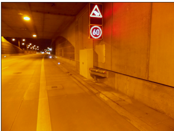
Bild 143: Exemplarisch: Messcontainer nahe Tunnelportal
