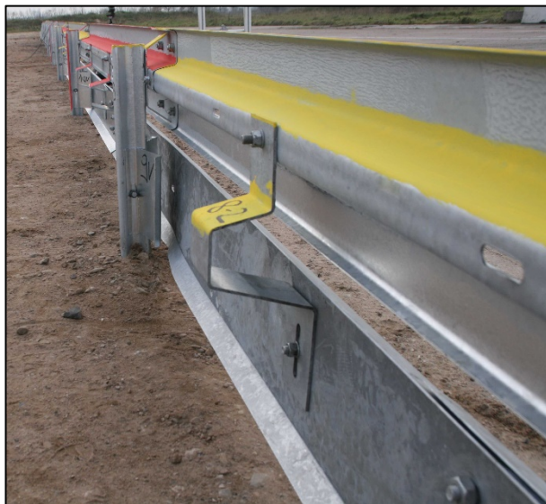
Bild 36 Rückseite der Schutzeinrichtung nach dem Versuch
