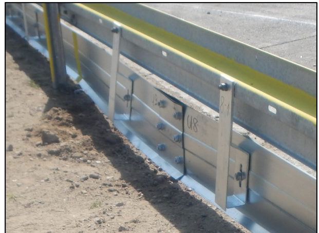
Bild 73 Rückseite der Schutzeinrichtung nach dem Versuch
