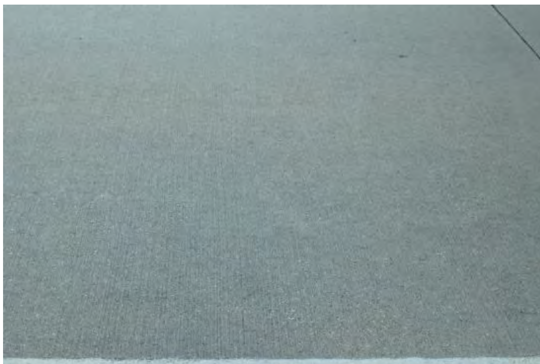
Bild 35 Baulos 1 (F): Zustand der Fahrbahnoberfläche (1. FS): Keine sichtbaren Schäden, Besenstrich quer sichtbar
