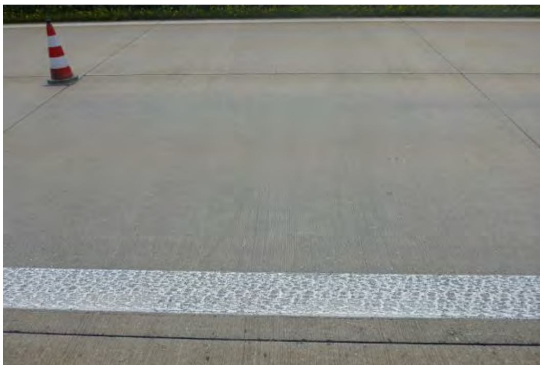
Bild 43 Baulos 3 (N1): Zustand der Fahrbahnoberfläche (1. und 2. FS): Keine sichtbaren Schäden, Besenstrich quer sichtbar
