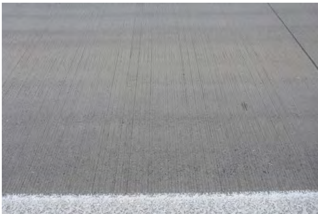
Bild 47 Baulos 4 (N2): Zustand der Fahrbahnoberfläche (1. FS): Keine sichtbaren Schäden, Besenstrich quer sichtbar
