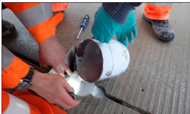
Bild 110: Verschluss eines Sensorsystems mit einem speziellen Betonersatzsystem
