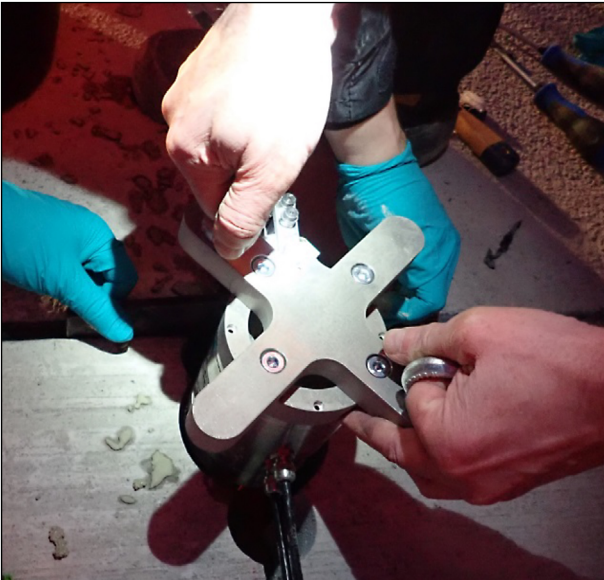
Bild 106: Installation eines Sensorsystems mit aufmontiertem Hilfskreuz und Einbaulehre
