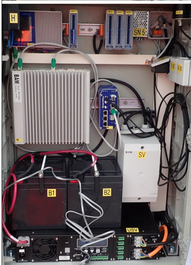
Bild 14: Fertig konfekionierter Schaltschrank von innen mit allen darin befindlichen Komponenten
