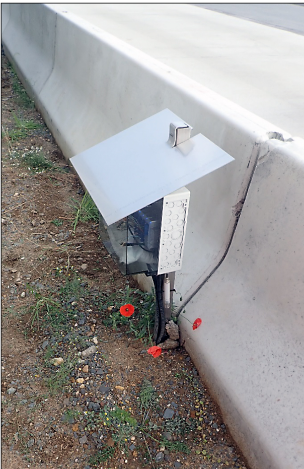
Bild 16: In situ installierter Messverteiler hinter der Leitplanke
