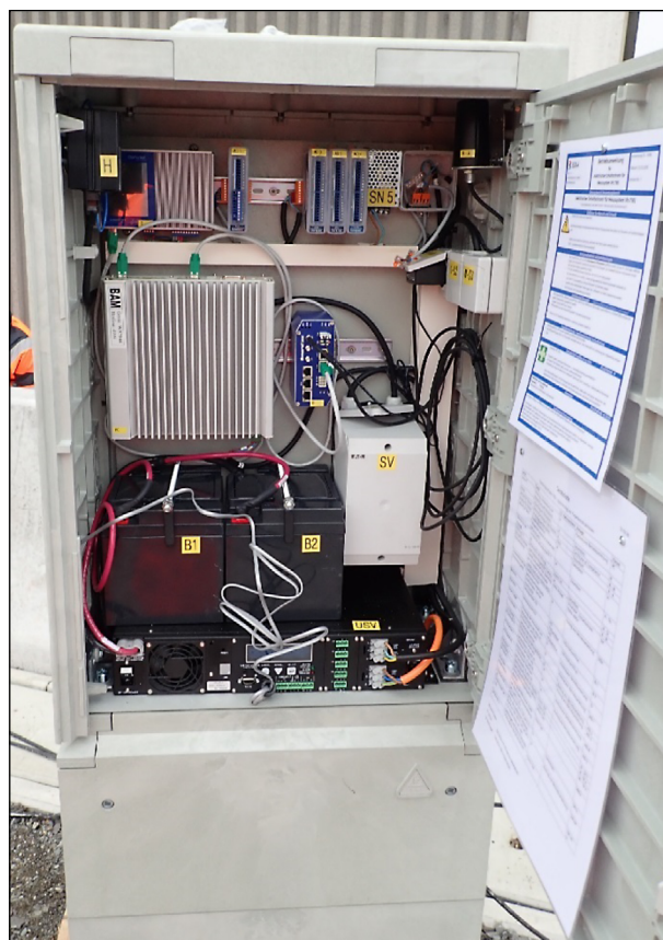
Bild 292: Fertig konfektionierter Schaltschrank von innen mit allen Steuerungskomponenten
