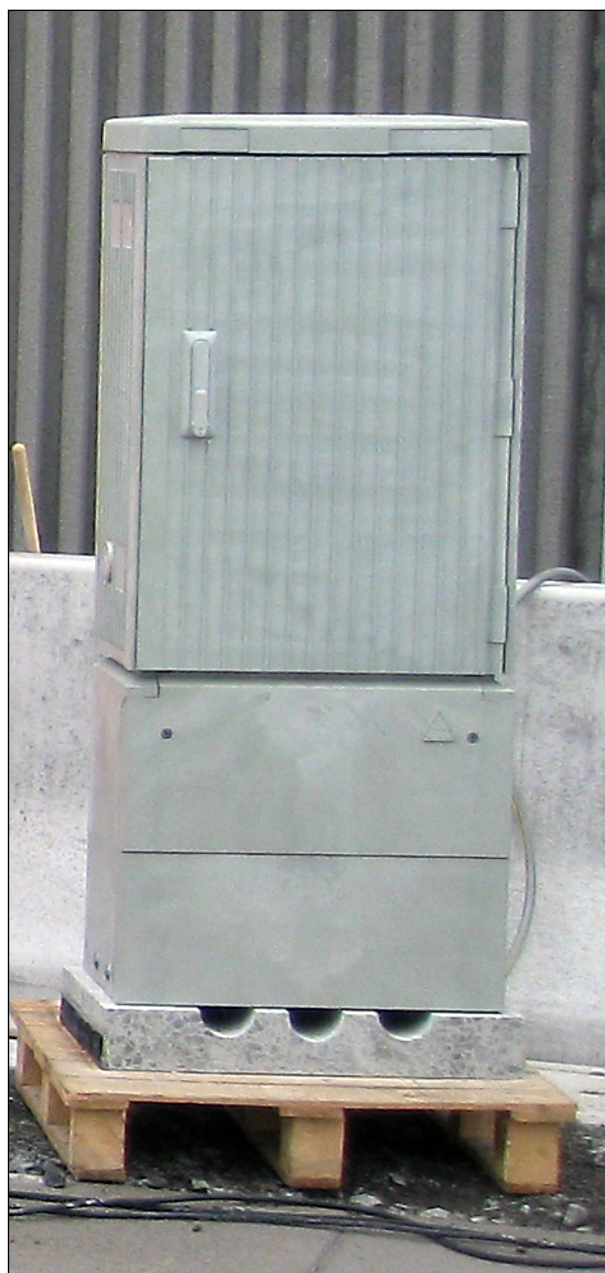
Bild 15: Fertig konfekionierter Schaltschrank mit Sockel von vorne
