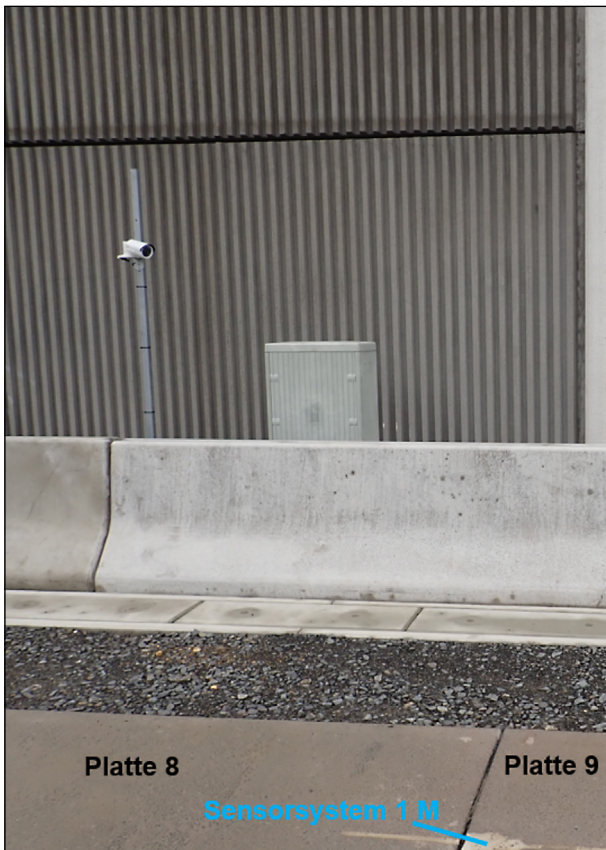
Bild 71: Schaltschrank in situ mit Kamera neben der Mitte der Platte 8
