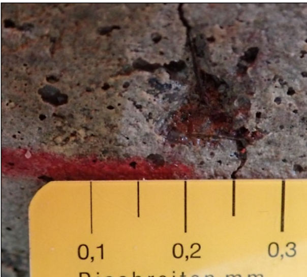
Bild 236: Fuge zwischen Platte 7 und 8 im März 2018; mit 0,25 mm nur geringe Ausbildung des Kerbrisses
