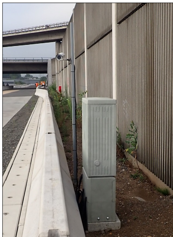
Bild 293: Teil der installierten Mess-Station in situ
