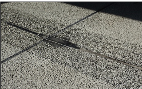
Bild 201: Sensorsystem 3M auf der Fertigteilbetonstrecke des duraBAST nach 100.000 Überrollvorgängen
