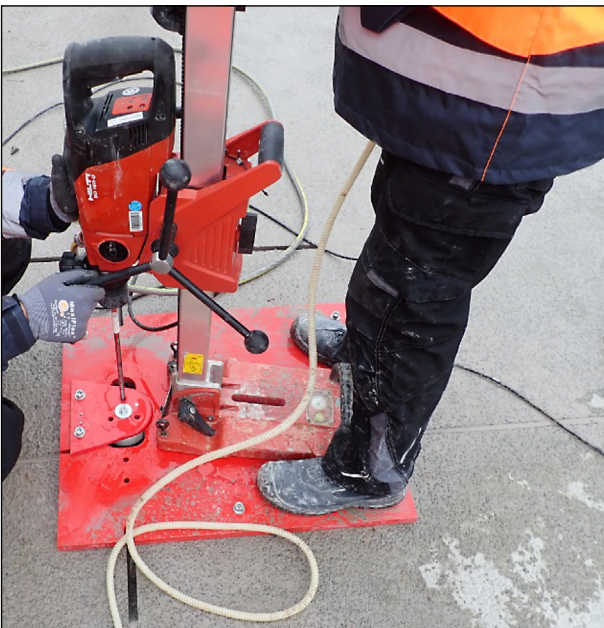
Bild 97: Bohrarbeiten der tieferliegenden Bohrlöcher für die Verankerung des Sensorsystems mit einer zweiten eingesetzten Bohrschablone
