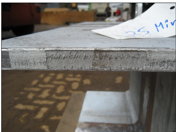
Bild 26: Arbeitsproben – Minderschichtdicken des Zinküberzuges im Bereich der Brennschnittfläche (IFG)
