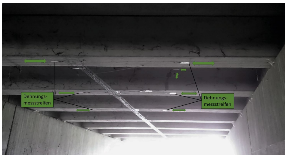
Autobahnbrücke mit Sensorik zur Gewichtserfassung von Fahrzeugen (Bridge-WIM)
