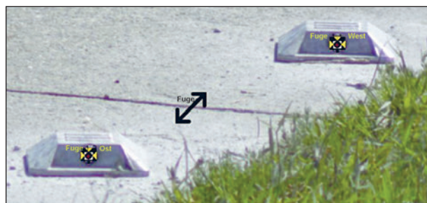
Bild 50: Auf der Fahrbahn montierte Monitoringprismen
