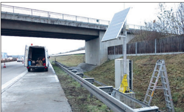
Bild 33: Stromversorgung des Messsystems mithilfe von Solarzellen
