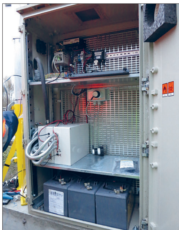
Bild 32: Aufbau einer Übertragungsstation
