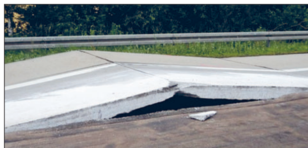
Bild 21: Hitzeaufbruch mit einem Ausweichen der Platten nach oben
