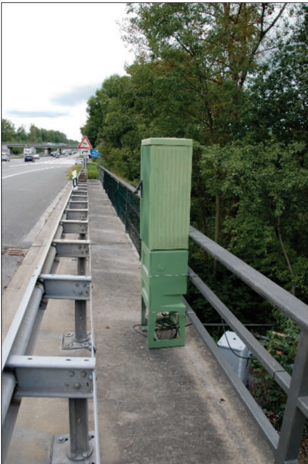
Bild 25: Baustromverteiler auf dem Brückenbauwerk
