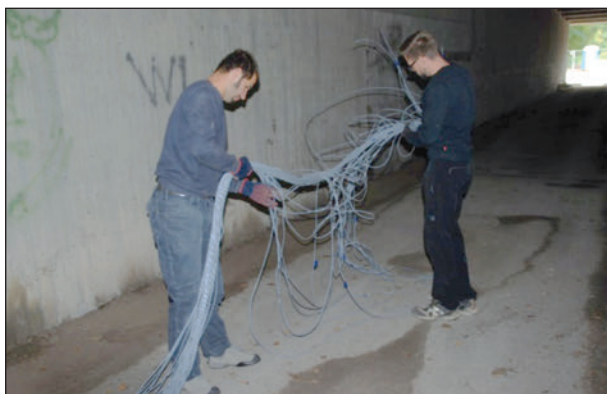
Bild 57: Aufwickeln der Kabel
