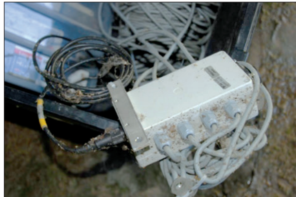
Bild 38: Zustand Signalverteiler bei der Demontage
