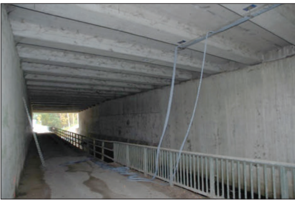
Bild 51: Führung der Kabel entlang des Geländers
