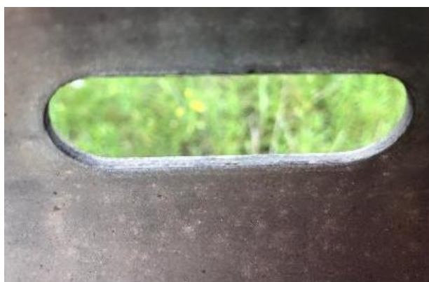
Bild 5: Stanzloch am Schutzplankenholm nach 18-jährigem Einsatz am Mittelstreifen ohne jegliche Anzeichen von Rotrost.
