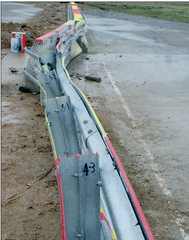
Bild 4-106: Durchbiegung der Schutzeinrichtung; Blick in Anfahrriichtung
