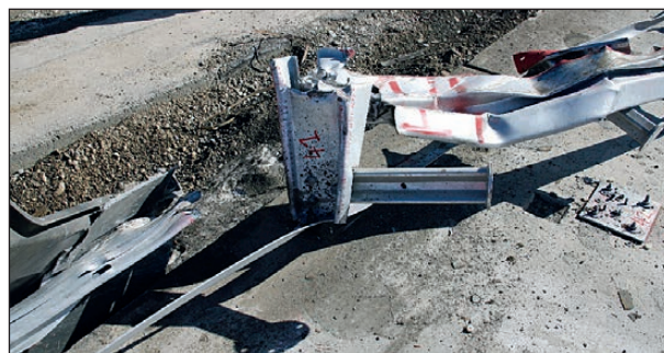
Bild 4-71: Detailansicht des gerissenen Holmes 11 im Bereich des Distanzstücks 41
