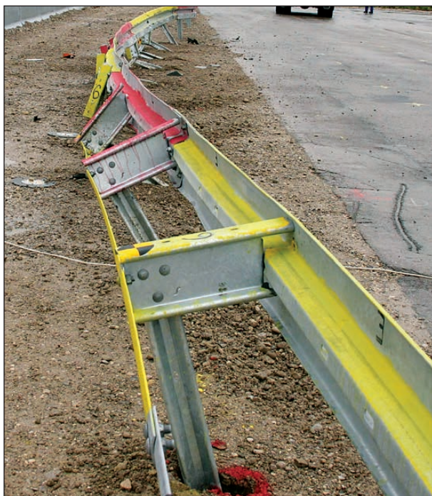
Bild 4-178: Durchbiegung der Schutzeinrichtung; Blick in Anfahrtrichtung
