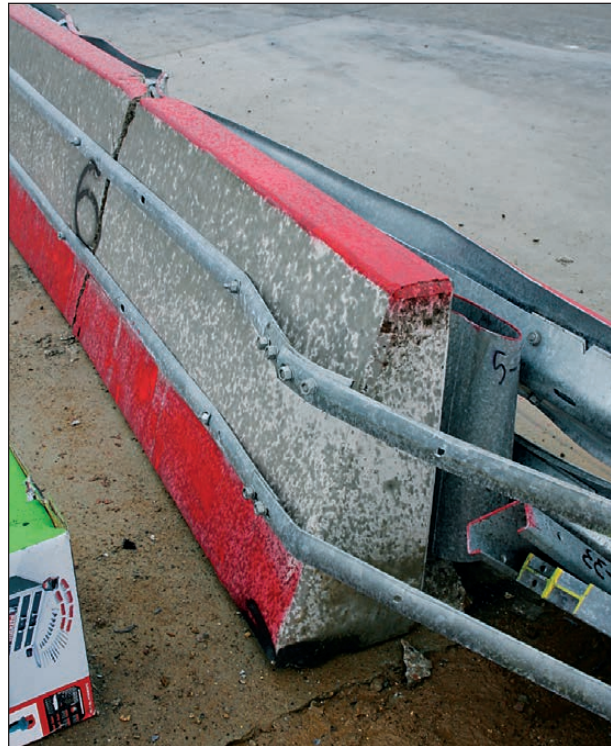
Bild 4-107: Durchgehender Riss im Element 6; Blick auf die Systemrückseite
