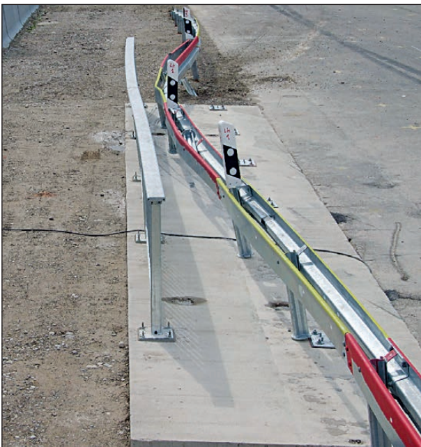
Bild 4-206: Durchbiegung der Schutteinrichtung und des Geländers; Blick in Anfahrtrichtung; Quelle: TÜV Süd
