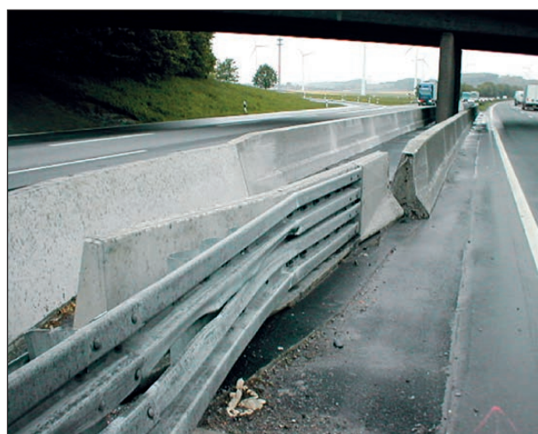
Bild 2-8: Unfall an Übergangskonstruktion nach [ARS 17/1996] in NRW; Quelle: Straßen.NRW
