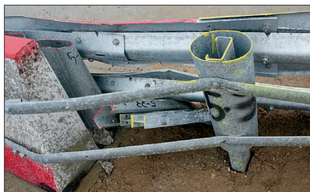
Bild 4-103: Detailansicht der Schäden im Bereich des Holmstoßes 5/6; Blick auf die Systemrückseite
