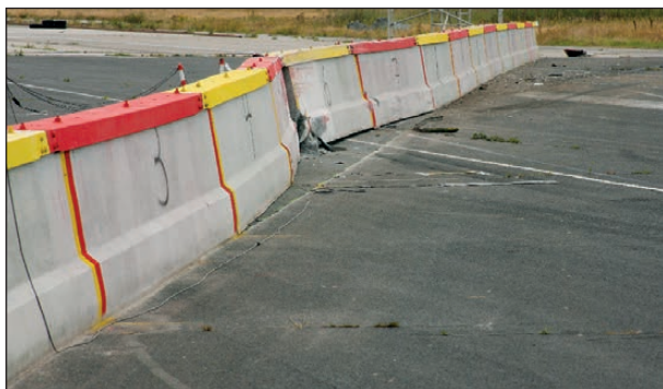
Bild 4-127: Durchbiegung der Schutzeinrichtung; Blick in Anfahrriichtung
