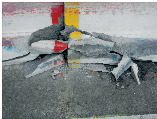
Bild 4-129: Detailansicht Betonabplatzungen am Fuß der Elemente 5/6 auf der Anprallseite; Quelle: DEKRA
