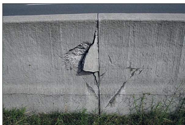
Bild 2-14: Abplatzungen im Bereich der Scheinfuge
