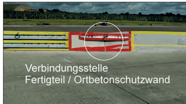
Bild 2-11: Schwachstelle 1 der Übergangskonstruktion aufgrund des 1. Sanierungsversuchs von Straßen.NRW; Quelle: DEKRA/BAST
