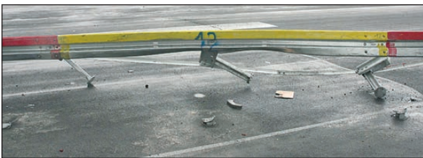
Bild 4-30: Schäden im Bereich Holm 12
