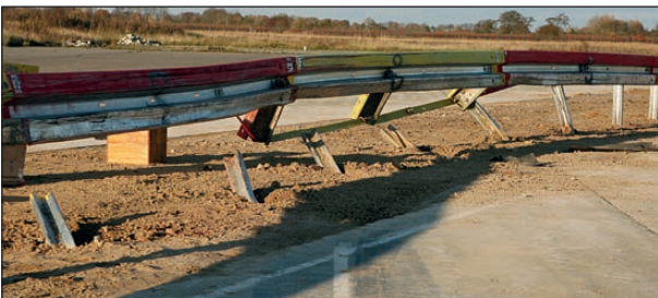
Bild 4-226: Schäden im Bereich der Holme 7 – 9
