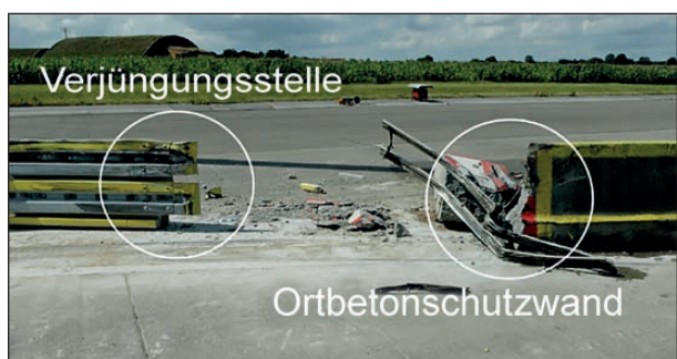
Bild 2-12: Schwachstelle 2 der Übergangskonstruktion aufgrund des 1. Sanierungsversuchs von Straßen.NRW; Quelle: DEKRA/BAST
