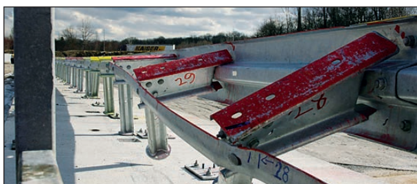
Bild 4-58: Detailansicht Systemrückseite im Bereich des Holms 10 mit den aus der Verankerung gehobenen Pfosten
