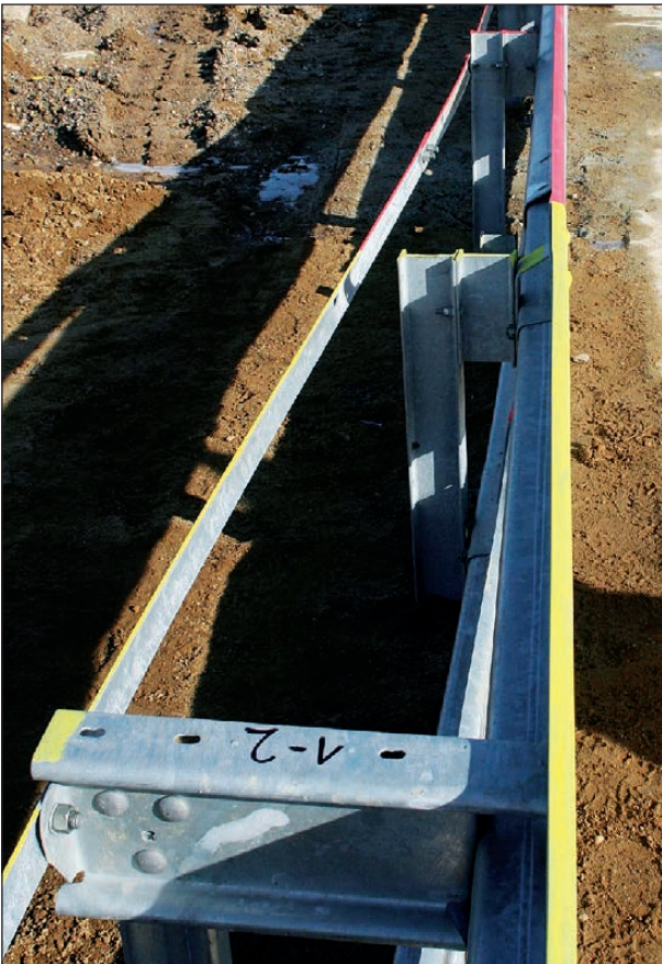
Bild 4-87: Übergang innerhalb des Stahlteils der ÜK (von Sigma-Pfosten mit Abstandhalter auf „doppelte“ IPE-Pfosten)
