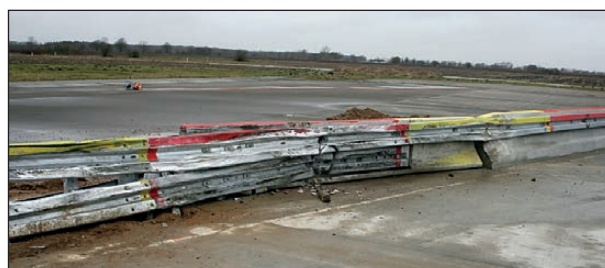
Bild 4-102: Beschädigungen im Bereich der Kontaktstrecke
