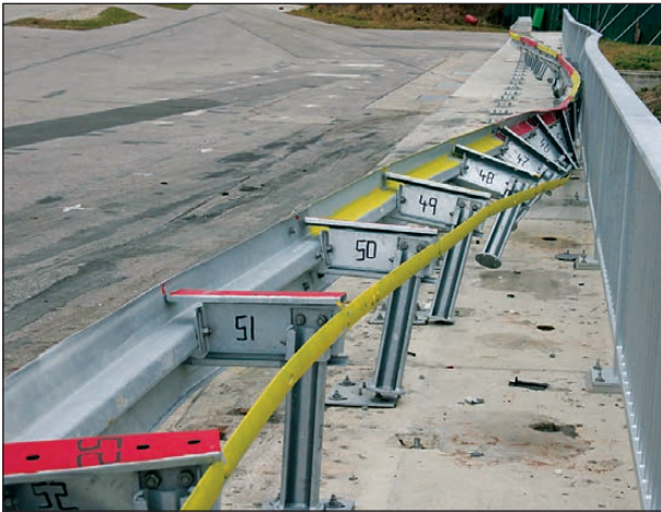
Bild 4-81: Durchbiegung der Schutzeinrichtung; Blick entgegen der Anfahrriichtung
