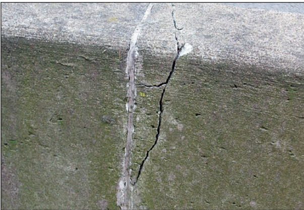
Bild 2-16: Rissbildungen außerhalb der Scheinfugen
