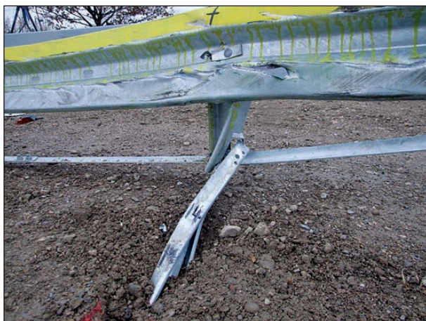
Bild 4-176: Element 7 – eingerissener Holm; Quelle: TÜV Süd
