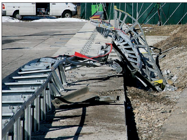
Bild 4-68: Durchbiegung der Schutzeinrichtung; Blick entgegen der Anfahrriichtung
