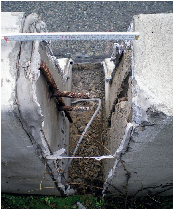
Bild 2-9: Verschiebung des Betonfertigteils infolge eines Durchbruchs; Quelle: Straßen.NRW
