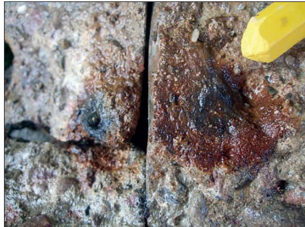
Bild 2-18: Korrodierte Bewehrung (Quelle: Straßen.NRW)
