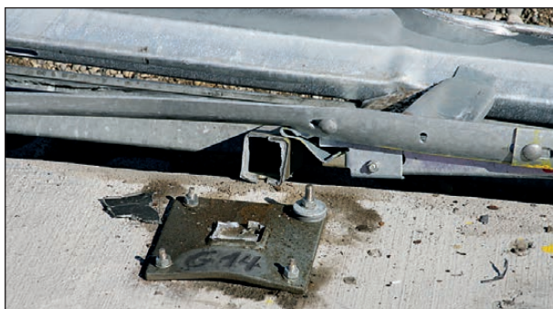
Bild 4-70: Detailansicht der aufgewölbten Fußplatte G14 des Geländers
