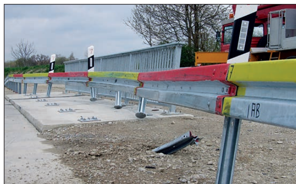
Bild 4-203: Abprallpunkt am Holm 7 kurz nach dem Stoß der Holme 6 und 7; Blick entgegen der Anfahrriichtung; Quelle: TÜV Süd
