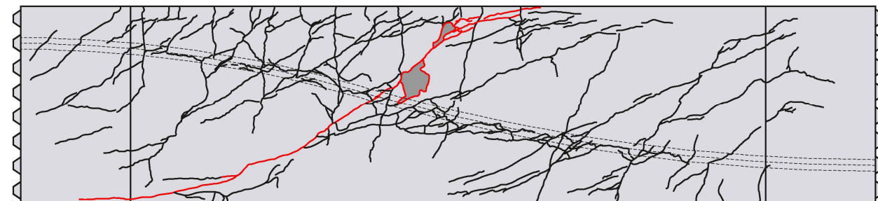
A 82: Rissbild, Laststufe Nachbruch
