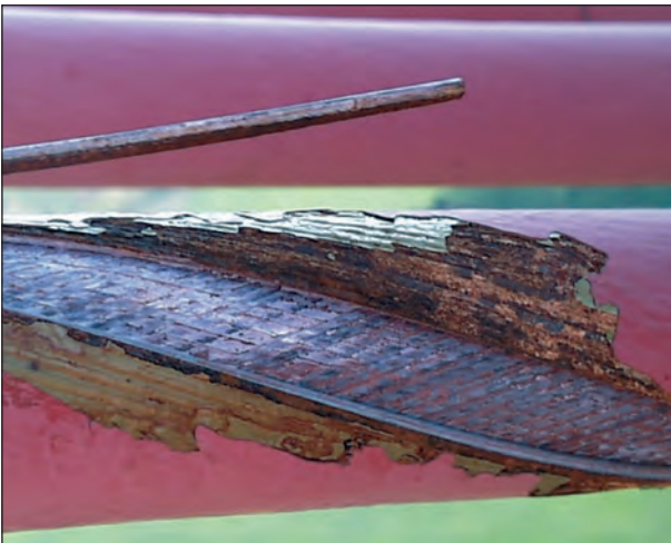
Bild 3.35: Drahtbrüche und Korrosionserscheinungen
