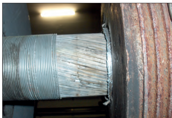
Bild 4.59: Drahtbrüche in der Nähe des Seilkopfes
