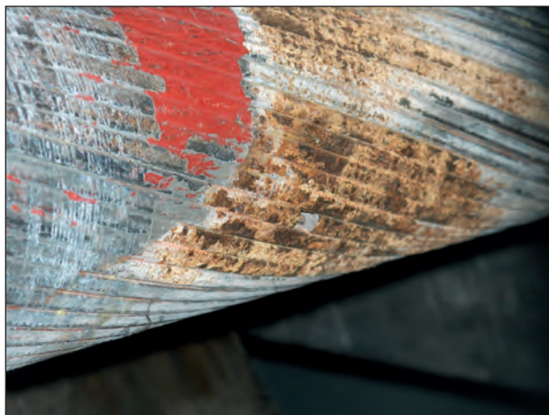
Bild 4.47: Erster Drahtbruch im Bereich mit ausgeprägter Korrosion
