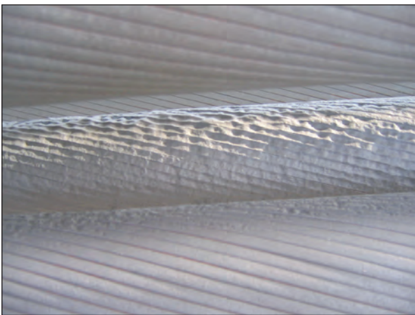
Bild 3.17: Verteilte korrodierte Bereiche bezogen auf den Seilquerschnitt
