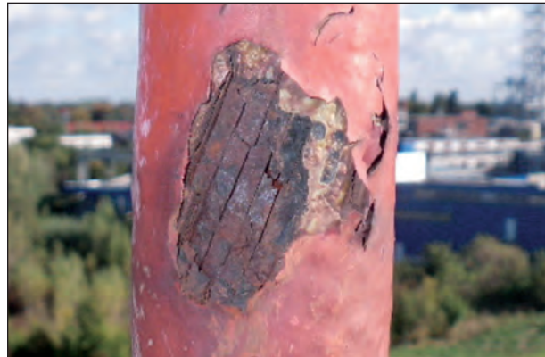
Bild 7.14: Korrodierte Stelle mit Drahtbruch
