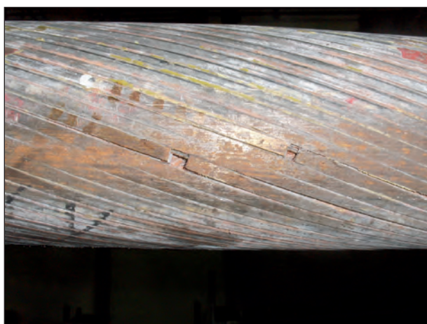
Bild 4.49: Zwei Drahtbrüche im leicht korrodierten Bereich
