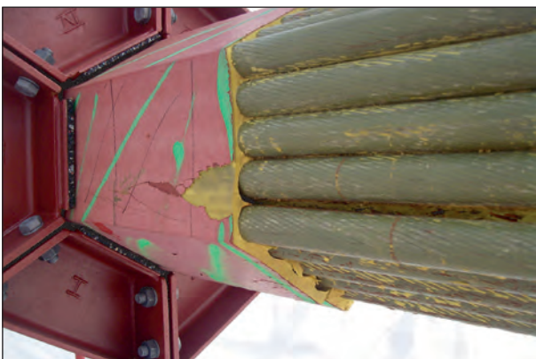
Bild 8.9: Teilweise wurde die Ummantelung entfernt
