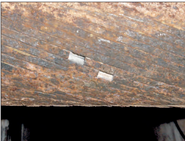
Bild 4.20: Nahaufnahme der beiden Drahtbrüche
