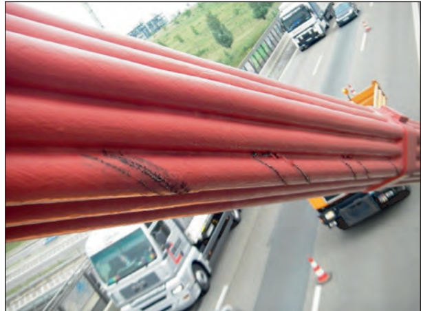
Bild 8.17: Beschichtungsschaden mit regelmäßigen Muster
