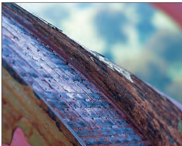
Bild 3.40: Detailbild zum Schaden
