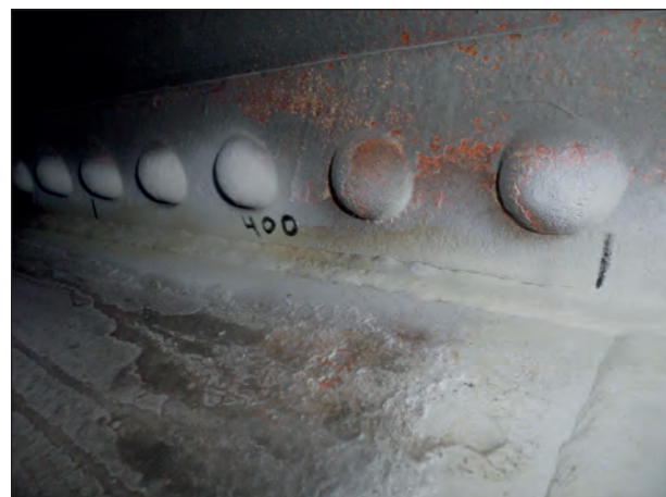
Bild 7.28: Detailbild mit Riss
