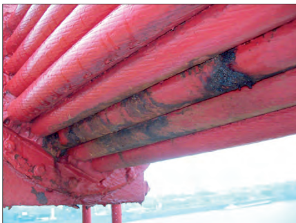
Bild 3.64: Feuchtigkeitsaustritt aus dem ummantelten Tragkabel an dem Tiefpunkt, hier ist keine Ummantelung
