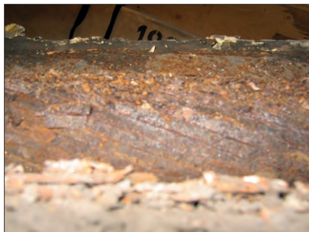
Bild 3.13: Starke Korrosion mit Blattrost
