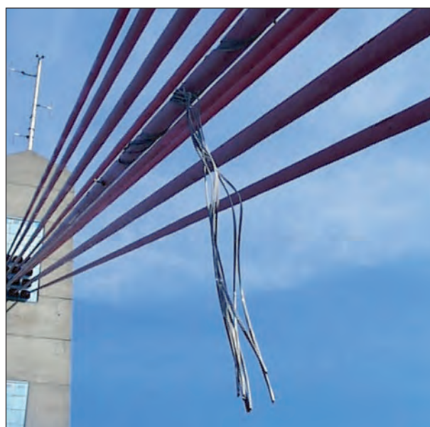
Bild 8.14: Drei Drahtbrüche mit Verlust des Verbundes
