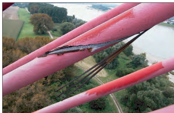
Bild 8.13: Drei Drahtbrüche mit Verlust des Verbundes
