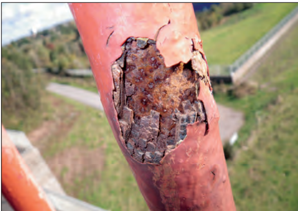
Bild 8.15: Mehrere Drahtbrüche mit bestehendem Verbund
