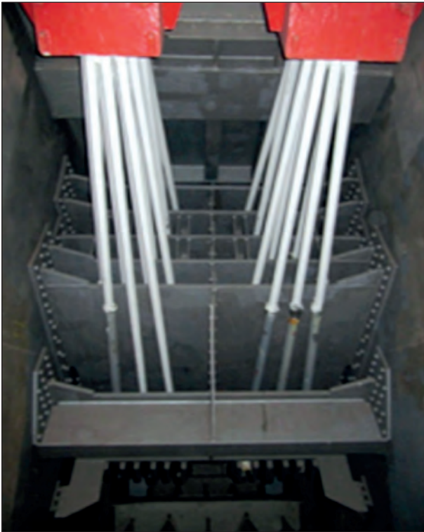
Bild 2.8: Seile vor den Traversen
