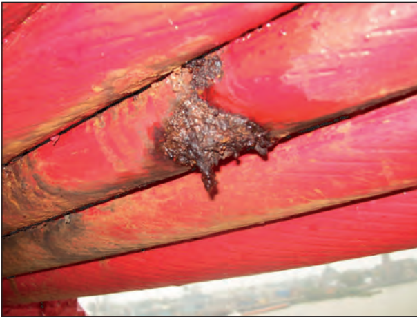
Bild 8.7: Austritt von Feuchtigkeit
