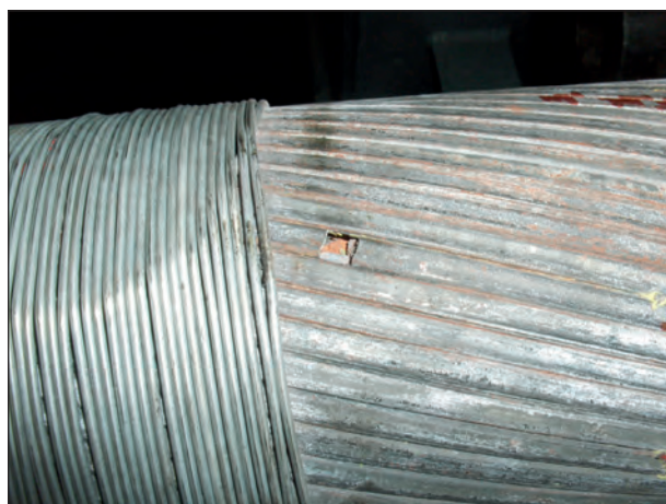
Bild 4.48: Drahtbruch außerhalb der Korrosionsstelle
