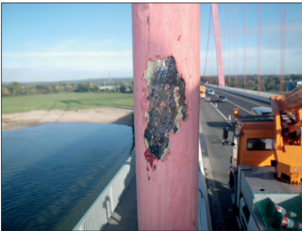
Bild 3.59: Beispiel für 2. Schadenkategorie: Beschichtung abgeplatzt, Untergrund Rost
