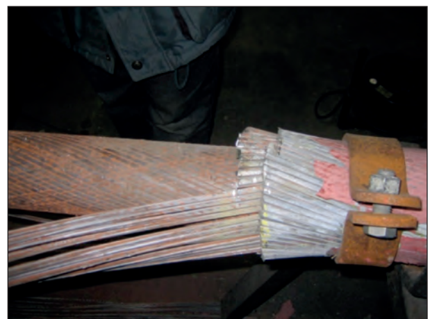
Bild 6.6: Geöffnetes Seil – 2. Drahtlage entfernt
