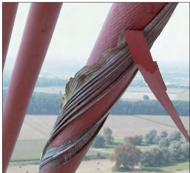
Bild 3.39: Schadensstelle mit Abhebungen und Unterrostungen
