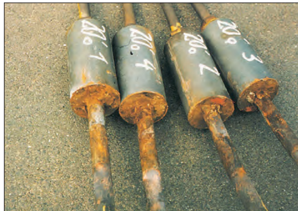
Bild 3.53: Korrosionsschäden im Bereich der Abdeckhauben (ausgebaute Hängerseile)
