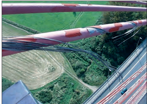
Bild 3.37: Drähte aus dem Verbund gelöst
