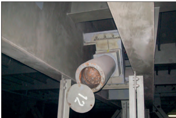
Bild 2.12: Verankerung der Einzelseile bei der Rheinbrücke Bonn Nord
