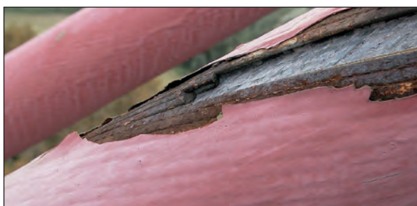
Bild 3.42: Schadstelle mit stark korrodierten Drähten
