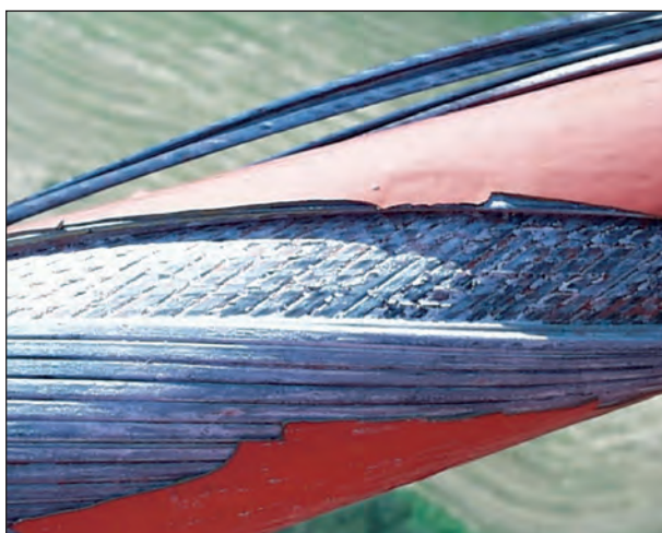
Bild 3.41: Schadenstelle mit Abschälungen, Weißrost, Rost und Reibspuren
