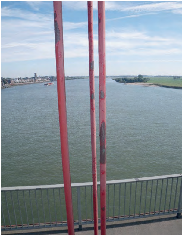
Bild 3.58: Beispiel für 1. Schadenkategorie: Deckbeschichtung abgeplatzt – hier: Konzentration von Schadstellen
