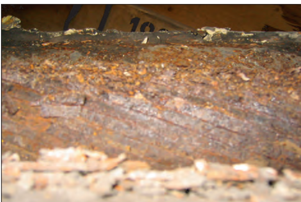
Bild 8.16: Starke Korrosion mit Blattrostbildung
