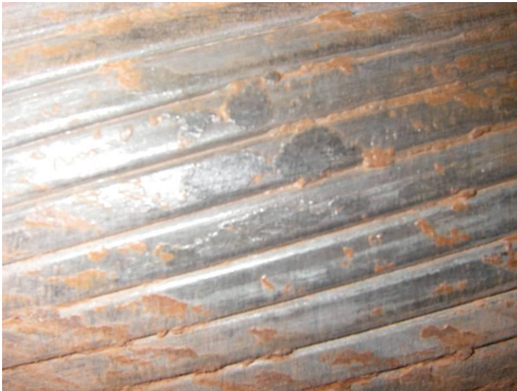
Bild 22 9. Drahtlage von Seilprobe 2 mit Unregelmäßigkeit in der Verzinkung
