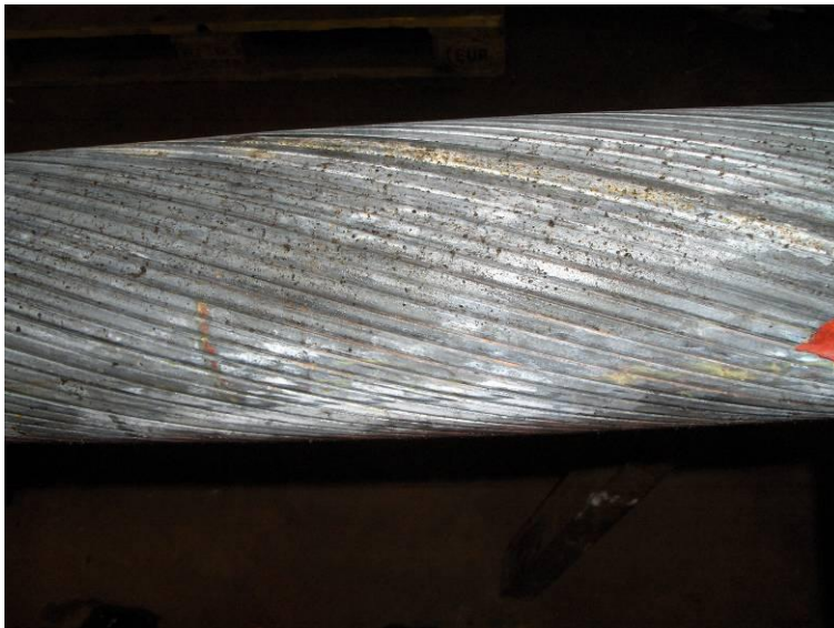
Bild 13 selektive (punktuell) Korrosion des Drahtwerkstoffes der Außenlage (Seilprobe 3)
