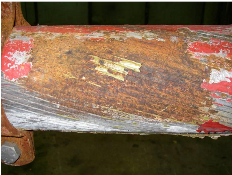
Bild 11 mäßige Korrosion von Außendrähten an Seilprobe 2
