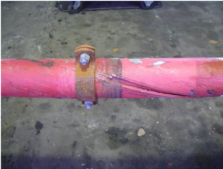
Bild 10 3 Drahtbrüche im Seil R100-2m (Seilprobe 2)
