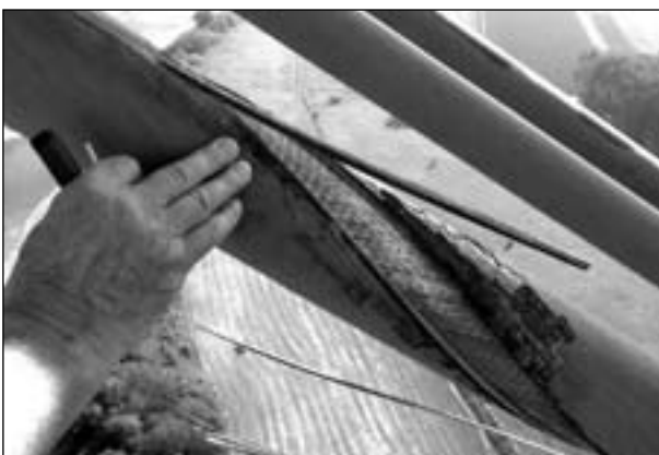
Bild 5: Drahtbrüche (Rheinbrücke Flehe)
