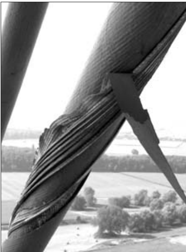
Bild 4: Infolge von Drahtbrüchen aus dem Seilverband gelöste Drähte (Rheinbrücke Flehe)
