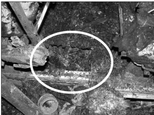
Bild 3.2: Durchbrand in den Innenraum
