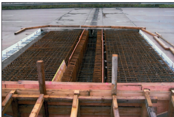
Bild 77: Trog mit Bewehrung für Herstellung einer Querkastenrinne in Betonbauweise
