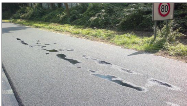
Bild 3: Mörtelanreicherungen an der Oberfläche [EHLERT, 2013]
