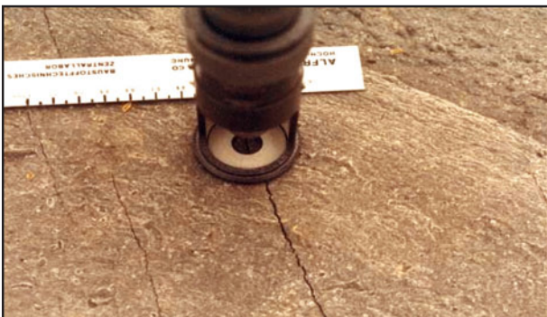
Bild 2–1: Durch Fröhschwinden hervorgerufene Risse im Beton
