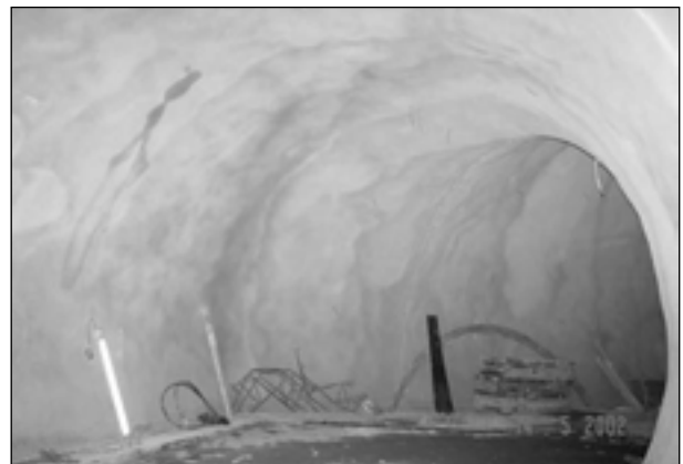
Bild 4-24: Feuchtstelle im Bereich der Blöcke 1 und 2 (2. Lage Spritzbeton, stahlfaserbewehrt)
