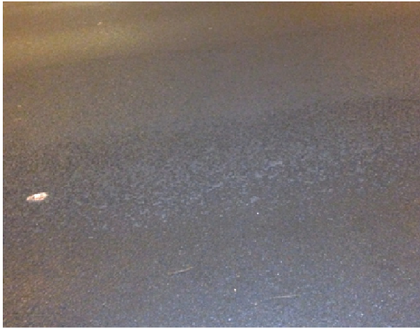
Bild 3.2-73: Durch Beanspruchung und Alterung entstandene Rauigkeit eines Dünnschichtbelags.
