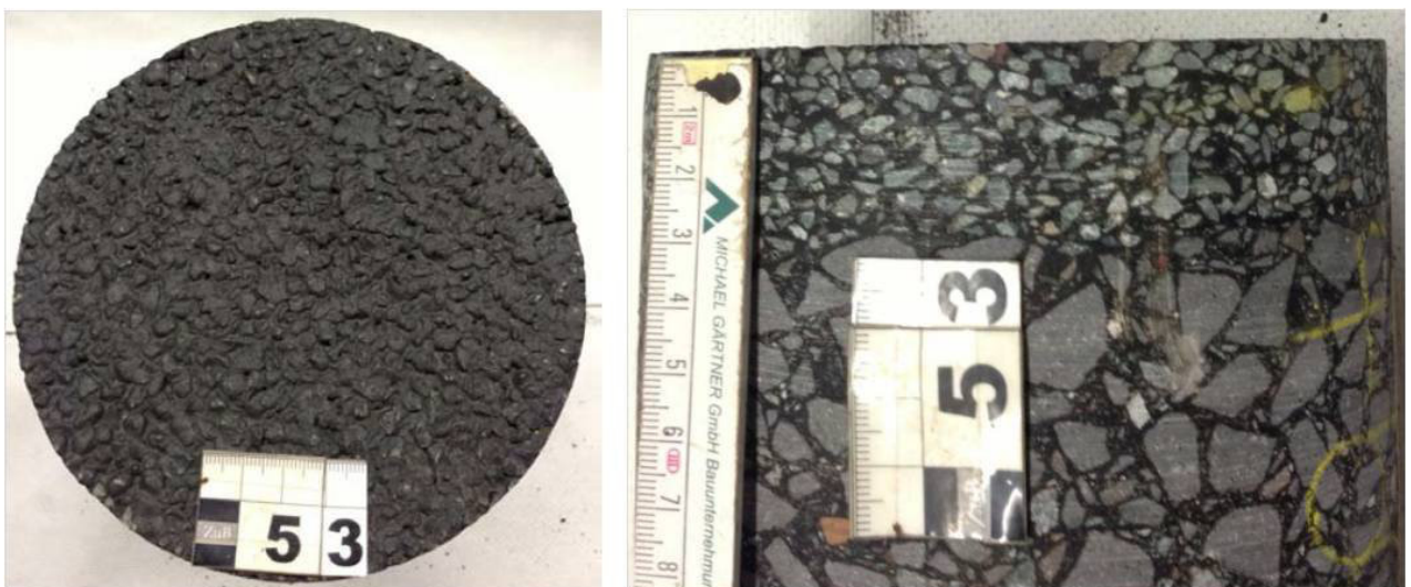
Bild 5.3-69: Beschaffenheit der Asphaltdeckschicht PMA 5 des Bohrkerns BK13 (im Bild 53) bei einem Hohlraumgehalt von 3,1 Vol.-%
