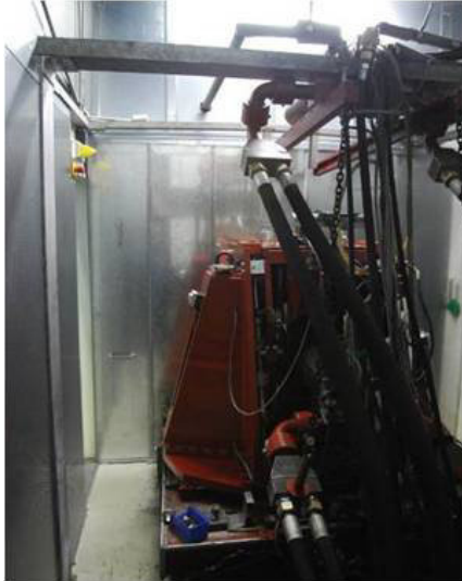
Bild 4.3-2: Antriebskammer und Trennwand mit Schallabsorbern
