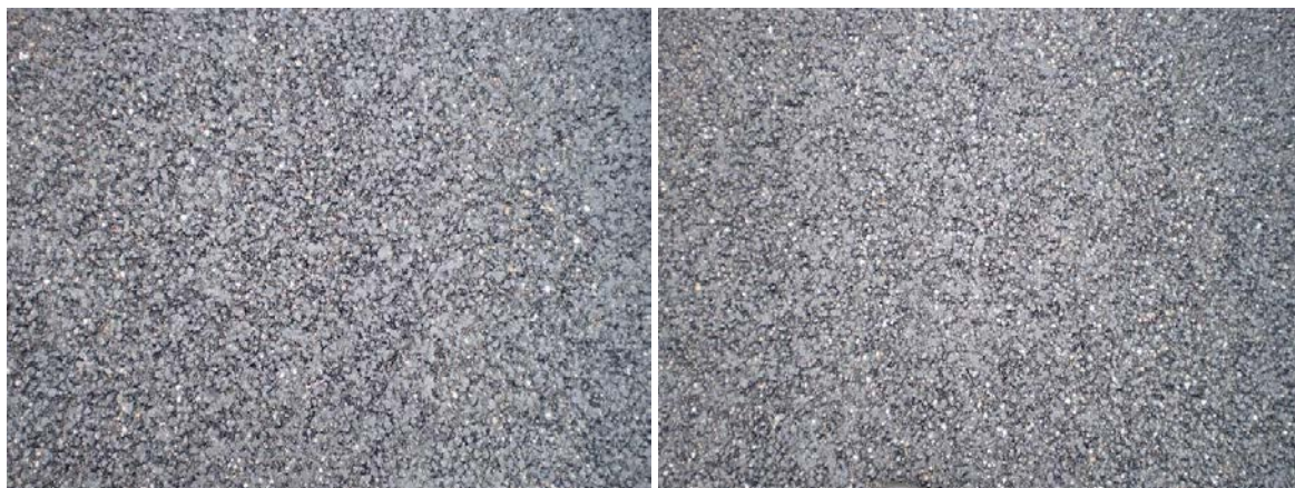
Abbildung 4-59: Oberfläche des Übergangsbereiches SMA 8 Hmb. Nullvariante zu SMA 8 Hmb. mit R1 nach der abgeschlossenen Walzverdichtung.
