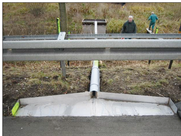
Bild 3.4: Auffangwanne mit abgedeckter Abflussrinne und Sammelbehälter – Standort Großburgwedel
