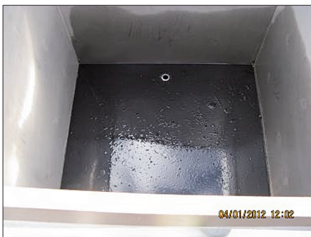
Bild 3-7: Standort Steinsfurt BAB A 6, 04.01.2012 – Sediment im Sammelbehälter nach Ablassen des Überstandwassers
