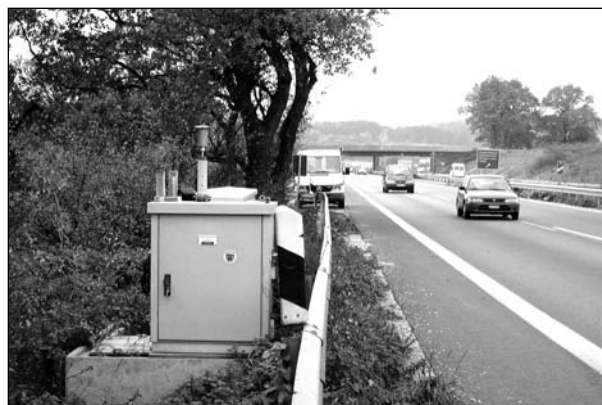
Bild 5.1: \text{PM}_{10} -Messstelle an der Autobahn A 8 bei Zusmarshausen
