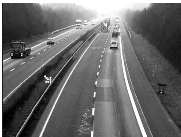
Bild 37: Vorgezogener kleiner Blinkpfeil bei Arbeitsstelle kürzerer Dauer mit Sperrung des linken Fahrstreifens mit Andreasstreifen auf der BAB A 61 bei Laudert (3.12.2003)
