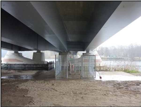
Bild 32: Platzierung des Versuchsstandes samt des Sicherheitszaunes unter der Brücke (Bauwerk 1. Bauabschnitt) am nördlichen Widerlager [Foto: DEGES GmbH]
