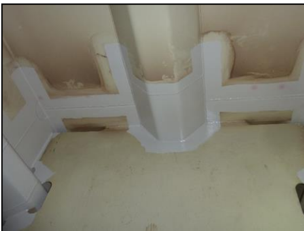
Bild 16: Vollständig beschichteter Baustellenmontagestoß im Inneren des Hohlkastens mit angrenzenden Verschmutzungen durch Schweißgase (Schmauch) [Foto: DEGES GmbH]
