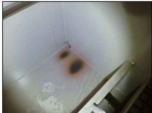
Bild 20: Verbrennung der Beschichtung (Durchbrände) infolge von Schweißarbeiten auf der Blechaußenseite [Foto: DEGEGS GmbH]
