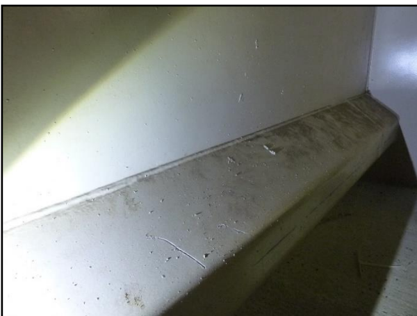
Bild 21: Mechanische Verletzungen [Foto: DEGEGS GmbH]
