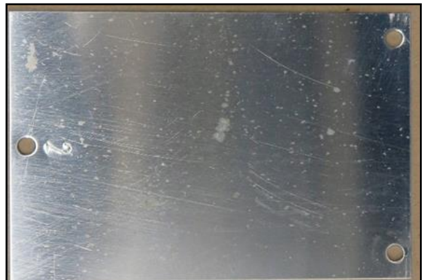
Bild 35: Zinkblech Vorderseite Bewitterung im Hohlkasten Achse C, im Bereich Einstiegs Luke zw. Achse 10/20
