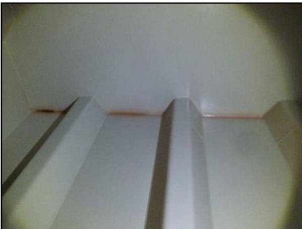
Bild 19: Verbrennung der Beschichtung (Durchbrände) infolge von Schweißarbeiten auf der Blechaußenseite [Foto: DEGEGS GmbH]
