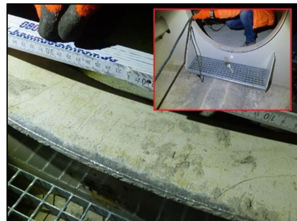
Bild 22: Mechanische Verletzungen [Foto: DEGEGS GmbH]
