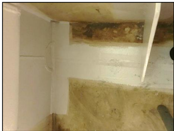
Bild 17: Starke Verschmutzung/Verfärbung der Werksbeschichtung [Foto: DEGES GmbH]
