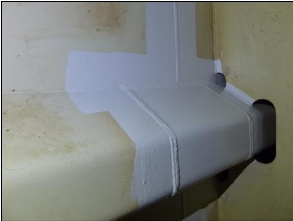
Bild 18: Starke Verschmutzung/Verfärbung der Werksbeschichtung [Foto: DEGES GmbH]
