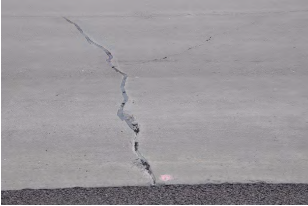
Abbildung 49: Durchgehender Querriss mit Ausbrüchen und Schrägriss
