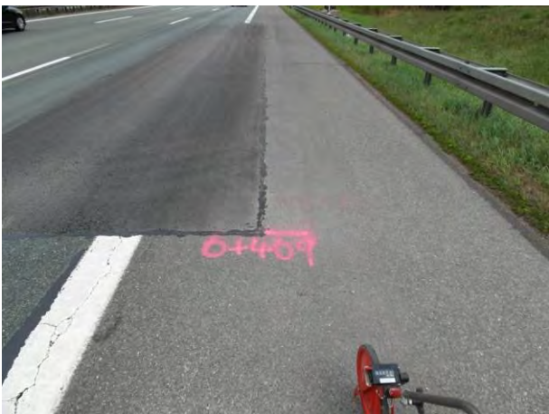
Abbildung 56: Flickstellen in der Asphaltdeckschicht
