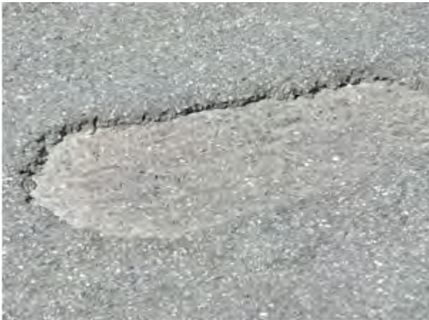
Abbildung 73: Beispielhafte Darstellung Ausbrüchen in der Asphaltdeckschicht
