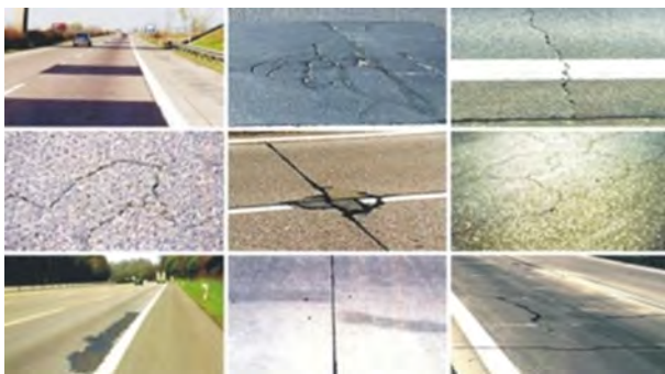
Abbildung 5: Schadensbilder der Oberfläche [BASt, Schadensbilder]
