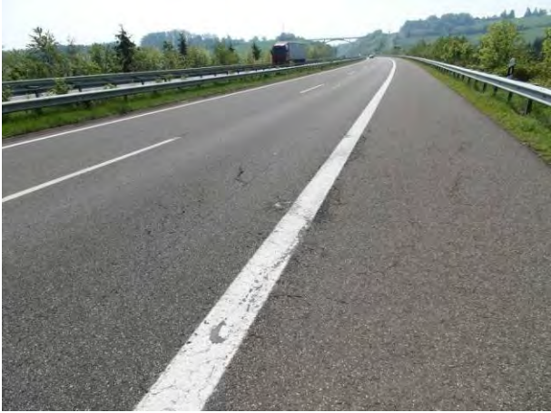
Abbildung 54: Risse in der Asphaltdeckschicht (unvergossene Einzel- und Netze)
