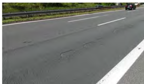
Abbildung 72: Beispielhafte Darstellung Ausbrüchen in der Asphaltdeckschicht
