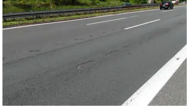
Abbildung 57: Ausbrüche in der Asphaltdeckschicht
