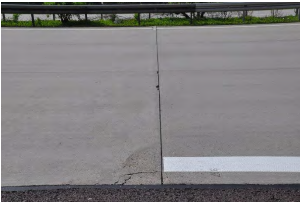
Abbildung 50: Kantenschäden und Eckabbruch
