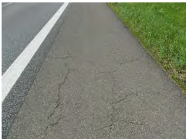
Abbildung 70: Beispielhafte Darstellung des sanierten Hauptfahrstreifens und der verbliebenen Risse im Seitenstreifen
