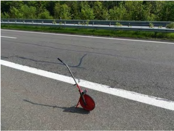
Abbildung 55: Risse in der Asphaltdeckschicht (teilweise vergossene Einzelrisse)
