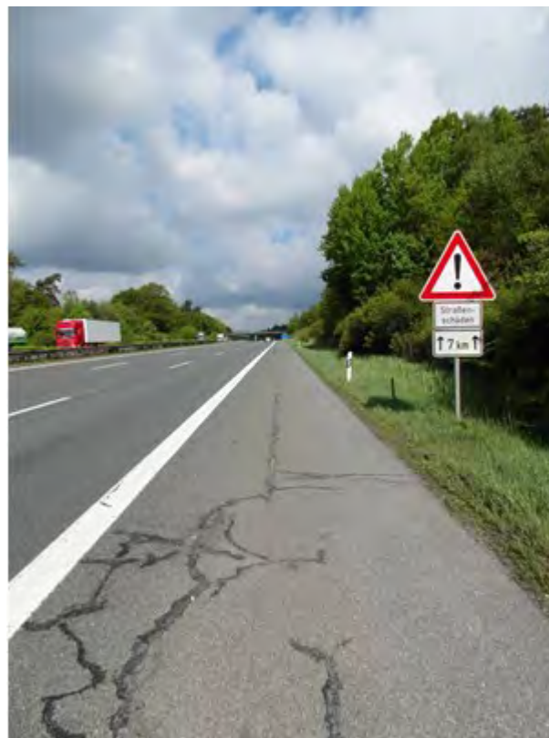
Abbildung 71: Beispielhafte Darstellung des sanierten Hauptfahrstreifens und der verbliebenen Risse im Seitenstreifen
