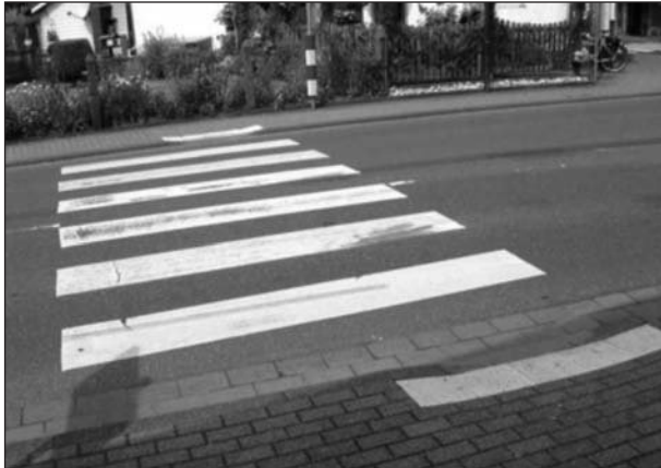
Bild 32: Minikreisverkehrszufahrt mit Rillenplatten aber ohne Hinführung
