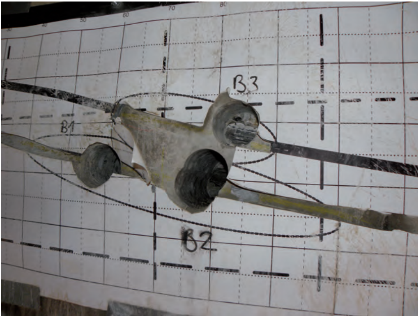
An den Verdachtsstellen wurden Bohrkerne entnommen
