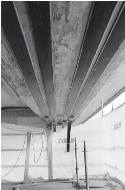
Angeklebte Lamellen unter dem Brücken-Längsträger im Bereich einer Koppelfuge
