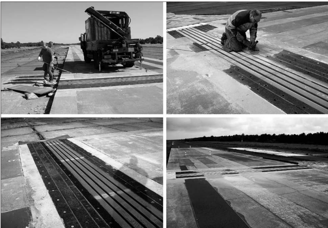
Bild 4.6.1-3: Einbausituationen in Sperenberg
