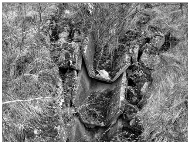
Bild 19: Zerstörter mit Trapezschaalen eingefasster Entwässerungsgraben, Aufnahme vom 28.03.2010
