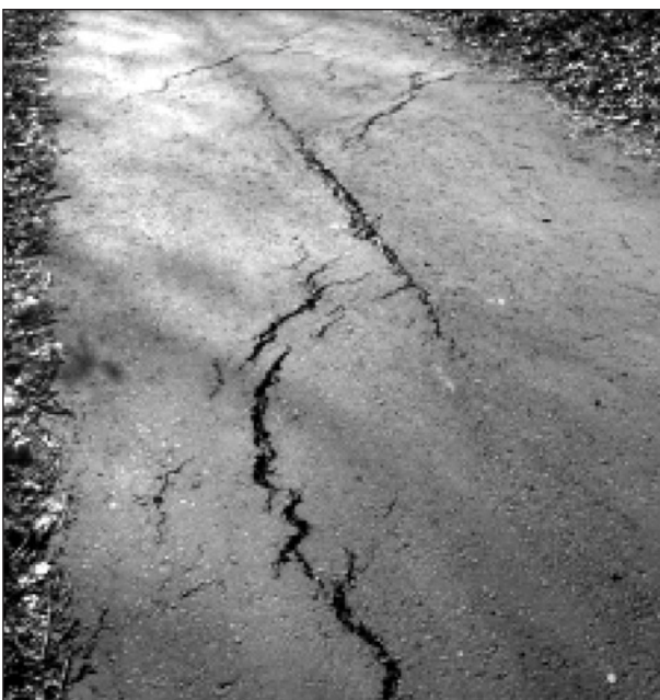
Bild 8: Risse in der Schwarzdecke des oberen Wirtschaftsweges, aus KRAUTER & LAUTERBACH, 2004
