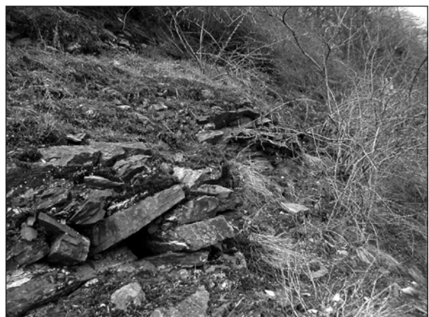
Bild 9: Verformung und Ausbrüche in der Böschungspflasterung, aus KRAUTER & LAUTERBACH, 2004
