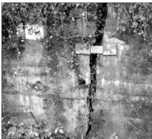
Bild 10: Riss in Betonstützmauer, aus KRAUTER & LAUTERBACH, 2004
