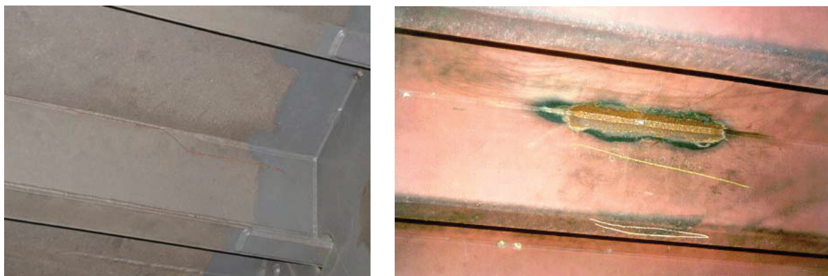
Bild 6: Risse in der Verbindungsnaht zwischen Deckblech und Längsrippe links: Sektkelchprofil rechts: Trapezprofil - instandgesetzte Naht zur späteren Prüfung noch ohne Beschichtung
