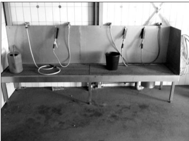
Bild 83: Stiefelwaschbank der Autobahnmeisterei Rodgau
