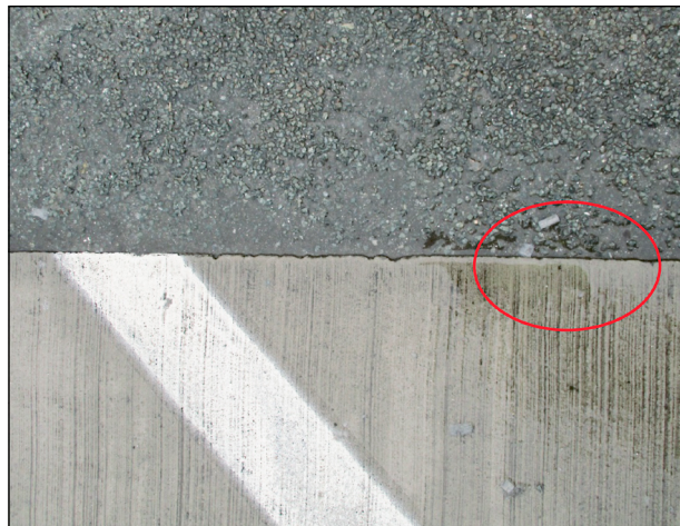
Bild 41: Kornausrüche im Übergangsbereich, OPB - Lkw Stellfläche (Beton), PWC-Anlage Silberbach
