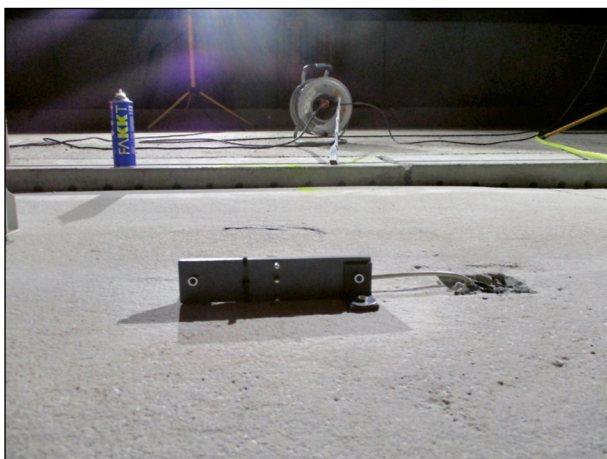
Bild 61: Messtechnik im OPB
