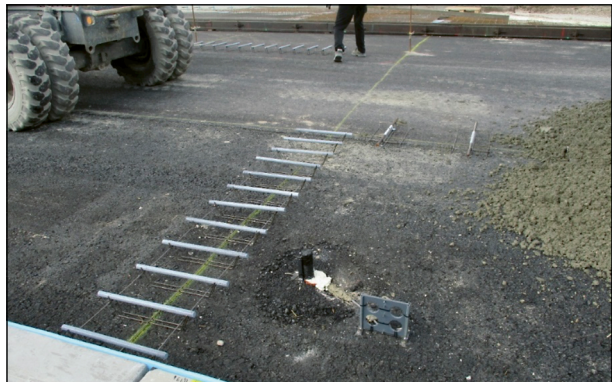
Bild 59: Messtechnik vor Überbauung mit UB
