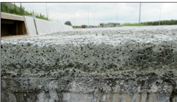
Bild 90: Übergangsbereich zum Asphalt, geschnitten
