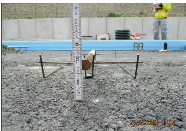
Bild 53: Ankerlage im Unterbeton
