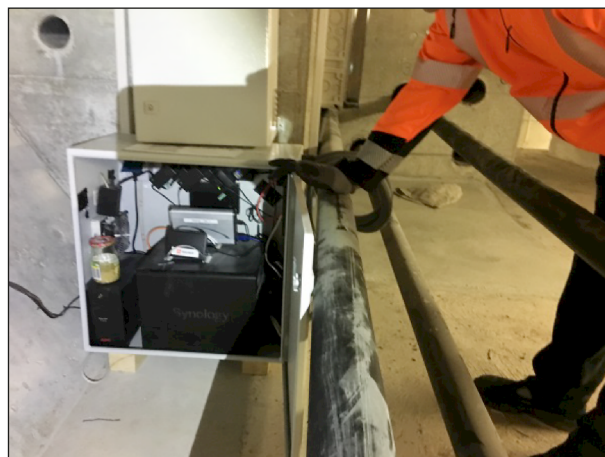
Bild 21: Messachse 50 Schaltschrank NAS
