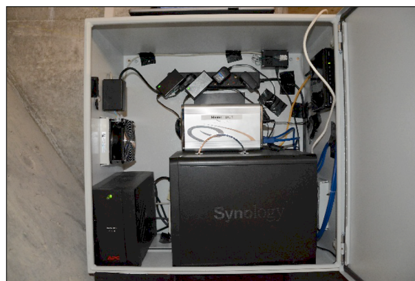
Bild 54: Fotografie des Schaltschranks UzL mit den genannten Geräten
