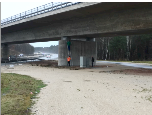
Bild 16: Achse 40 Lager 40.1 Reinigung Vogelschutz von außen
