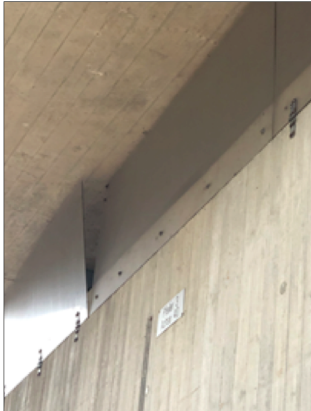
Bild 28: Achse 40 Lager 40.1 Vogelschutz einseitig abgerissen
