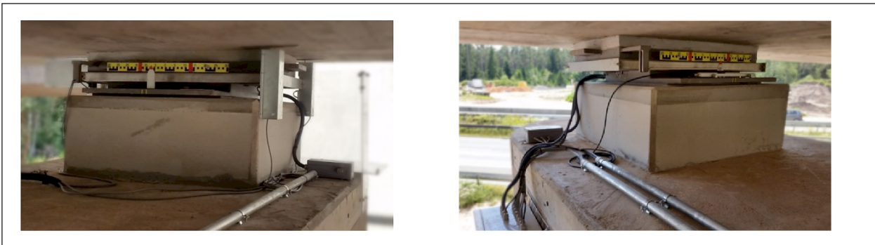
Bild 2: Links KGA 40/1 und Rechts KGA 40/3 im Bauwerk
