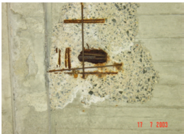
Bild 4-29: Freiliegendes und durchgerostetes Querspannglied von Innenseite des Hohlkastens (© Hessen Mobil)
