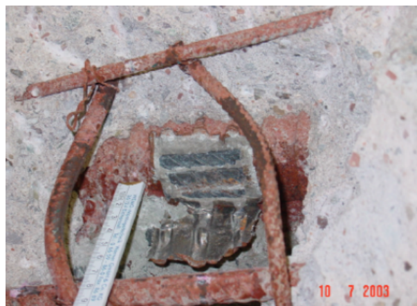
Bild 4-32: Freiliegende, korrodierte Spannglieder (© Hessen Mobil)
