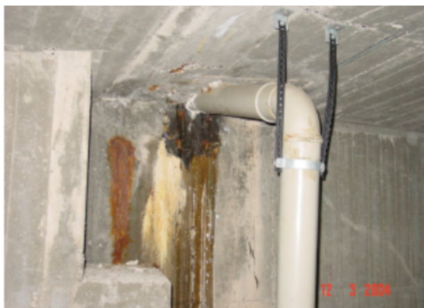
Bild 4-31: Schäden durch defekte Entwässerung, die über die Längsspannglieder in den Hohlkasten geführt wurde (© Hessen Mobil)
