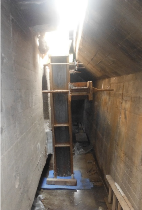
Bild 4-46: Längsfesthaltekonstruktion am Widerlager (© Adam Hörnig Baugesellschaft mbH & Co. KG)
