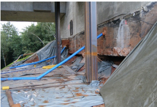
Bild 4-36: Widerlager unterspült (© thyssenkrupp Infrastructure)
