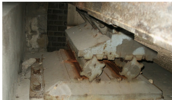
Bild 7-35: Korrosion an den Rollenlagern (© Schüßler-Plan)
