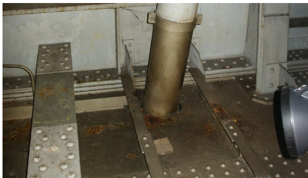
Bild 7-34: Korrosion infolge undichter Entwässerung (© Schüßler-Plan)
