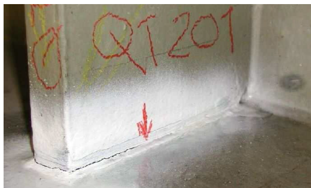
Bild 7-20: Schadensbild Untergrurt und Vertikalsteifen (© ABDN)
