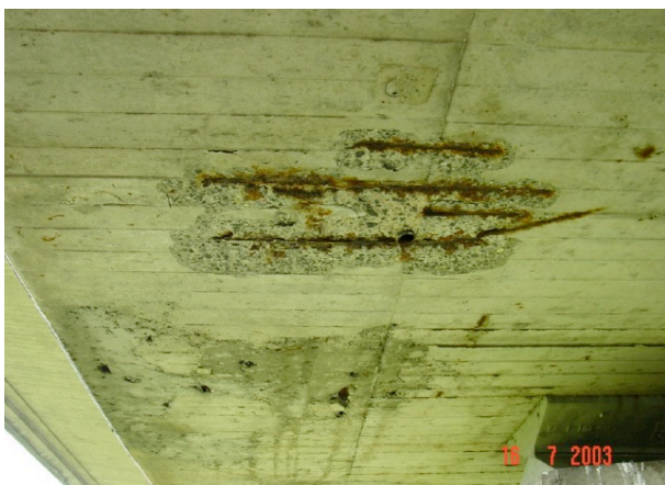
Bild 4-27: Schadensbilder Brückenprüfung Teilbauwerk West 2003 (© Hessen Mobil)
