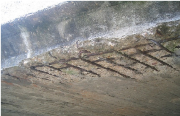
Bild 9-25: Freiliegende Bewehrung an der Bauwerksunterseite (© Schüßler-Plan)
