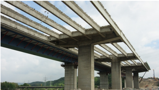
Bild 9-20: Ausgestemte Fahrbahnplatten (Quelle: DBV, Denis Kiltz)
