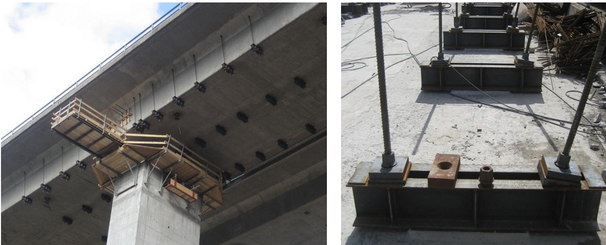
Bild 4-41: Ertüchtigung Überbau im Bereich der Zwischenstütze Achse 35 durch quer vorgespannten Hilfsquerträger und vertikale Vorspannung der Brückenstege (© Büchting + Steit AG)
