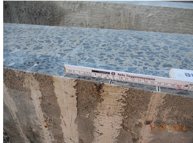
Bild 4-35: Verstärkung durch eingeschlitzte CFK-Lamellen an der Oberseite der Fahrbahnplatte (© Adam Hörnig Baugesellschaft mbH & Co. KG)
