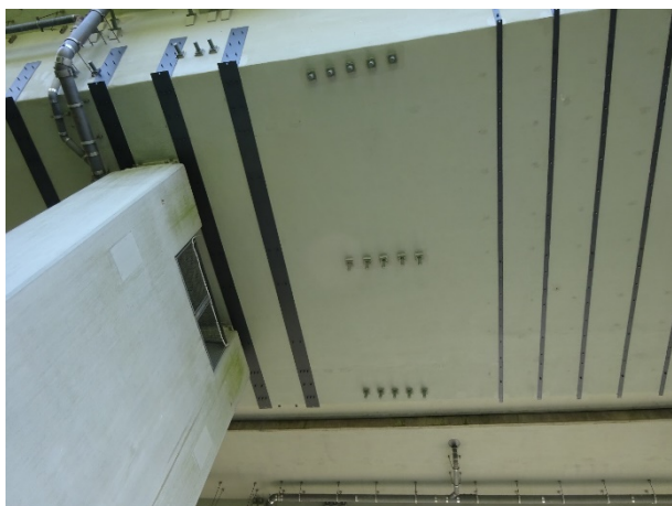
Bild 4-48: Bestandspfeiler und Untersicht des Bestandsbauwerks vor Beginn der Rückbauarbeiten (© Büchting + Streit AG)
