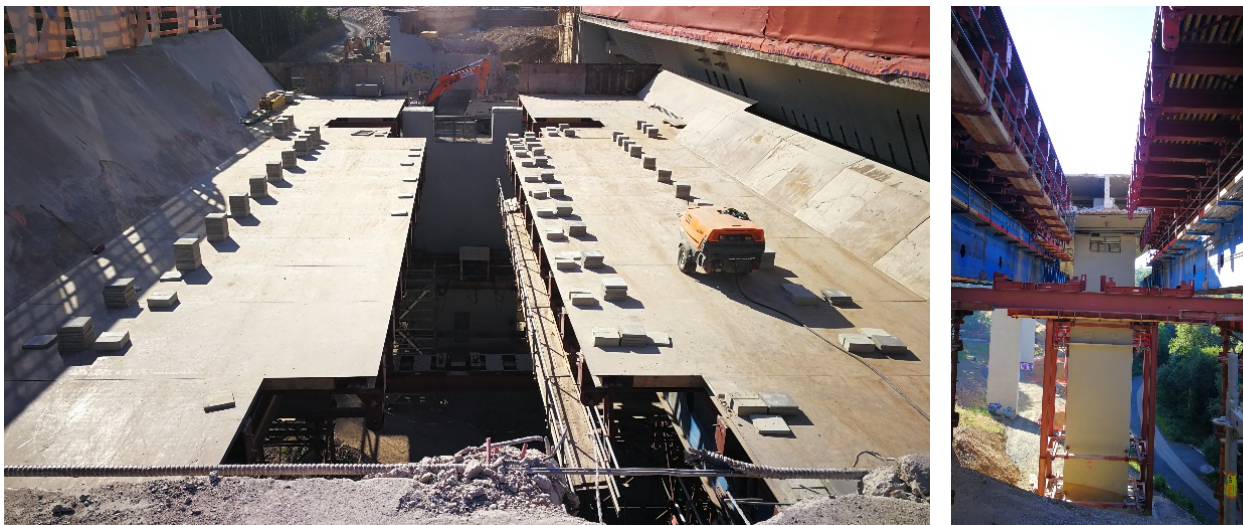
Bild 4-54: Teilbare, hydraulisch verschiebbare Grundrahmen bei Verschub des VSG in den 3. Abbruchabschnitt (© thyssenkrupp Infrastructure GmbH)
