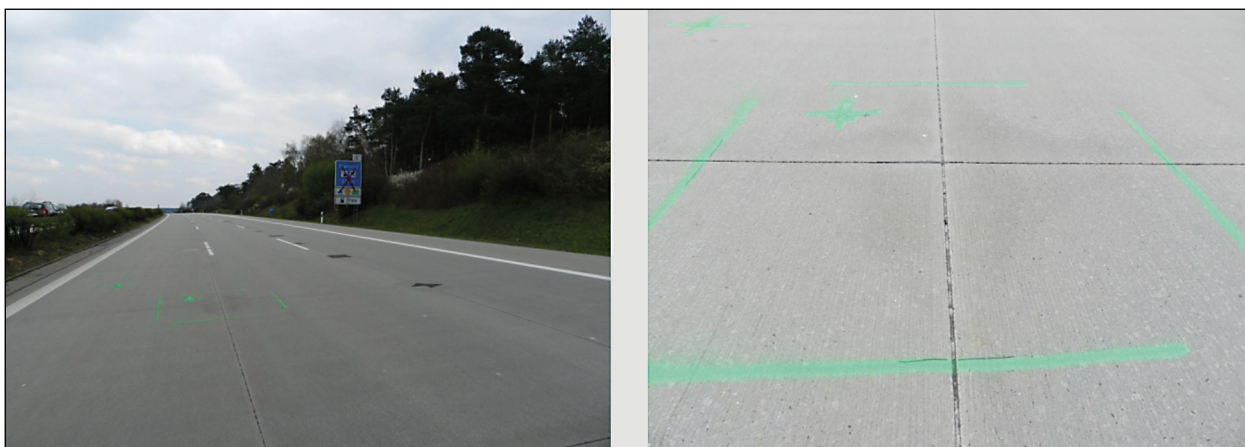
Bild 4-4: BAB A9, 1.ÜS/2.ÜS, Schadenskategorie I, Dunkelverfärbung im Bereich des Fugenkreuzes.
