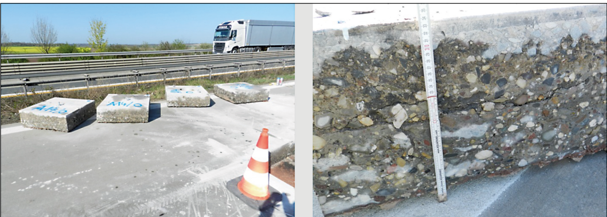
Bild 4-22: BAB A9, vier Ausbaustücke (links) und Ausbaustück mit Horizontalrissbildung (rechts).
