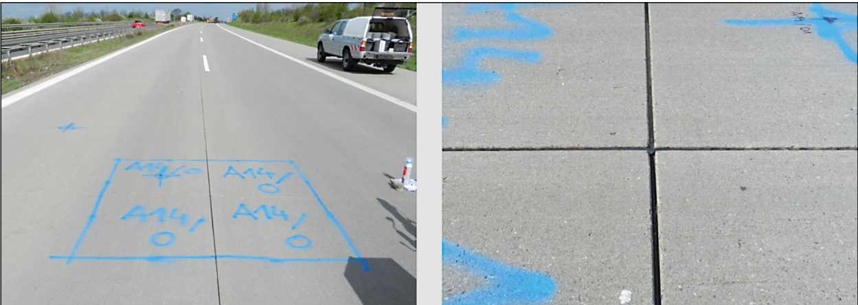
Bild 4-21: BAB A14, LS/1.ÜS, Schadenskategorie 0, an der Oberfläche keine Schäden sichtbar.
