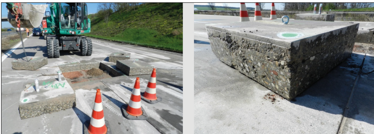
Bild 4-24: BAB A14, Ausbaustücke (links) und bereits ausgeprägte Horizontalrissbildung (rechts).
