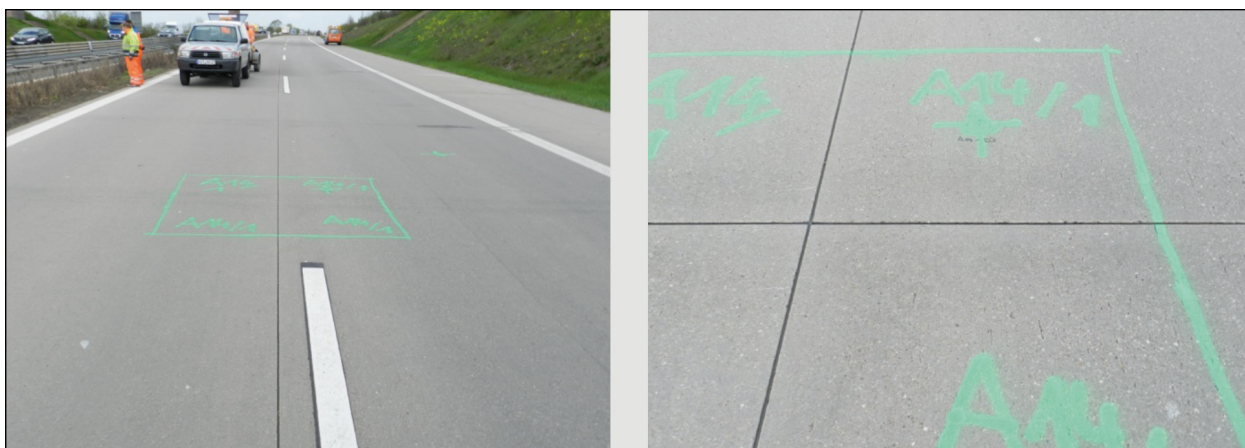
Bild 4-23: BAB A14, LS/1.ÜS, Schadenskategorie I, Dunkelverfärbung im Bereich des Fugenkreuzes.
