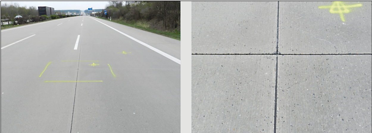
Bild 4-6: BAB A9, LS/1.ÜS, Schadenskategorie II, beginnende Rissbildung im Bereich der Fugenkreuze.
