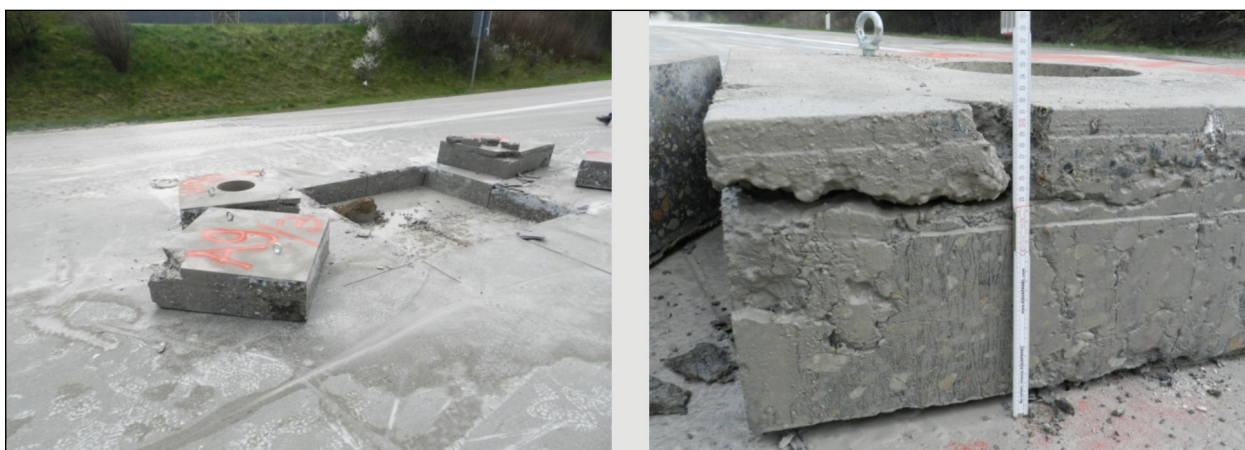
Bild 4-9: BAB A9, Ausbaustück (links) und Horizontalrissbildung mit Ausbruchstück (rechts).
