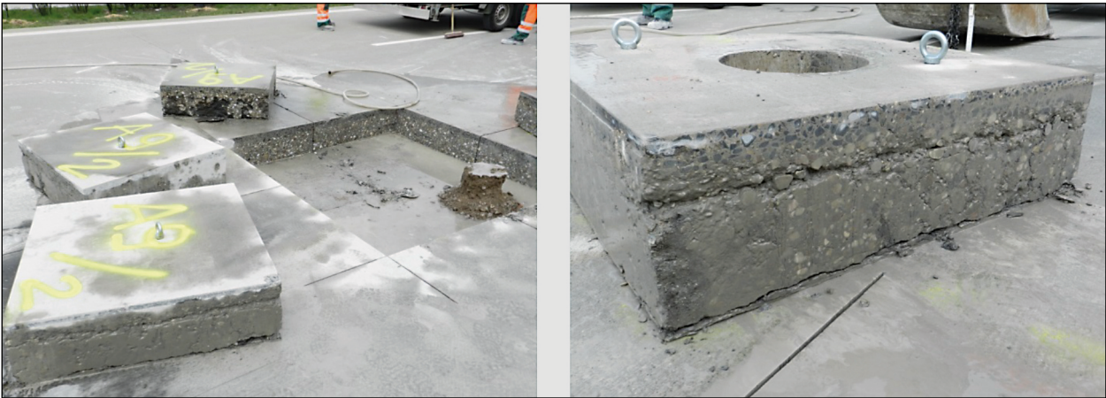
Bild 4-7: BAB A9, Ausbaustück (links) und deutlich ausgeprägte Horizontalrissbildung (rechts).
