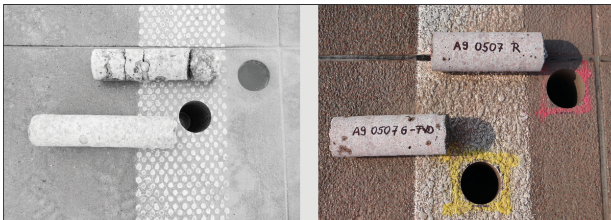
Bild 8-2: Links: Bohrkern mit und ohne Horizontalriss nahe Fugenkreuz (Abstand Bohrlochwandung zur Fuge rd. 3 und 21 cm) Rechts: Bohrkern ohne Horizontalriss an einer rd. 1,5 Jahre alten Betondecke (aus: MIELICH, 2019a).
