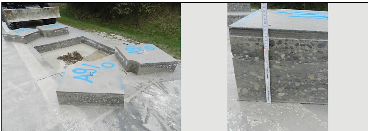
Bild 4-3: BAB A9, vier Ausbaustücke (links) und Ausbaustück mit Horizontalrissbildung (rechts).
