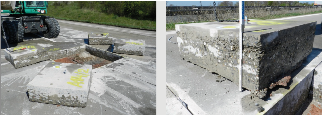
Bild 4-26: BAB A14, Ausbaustücke (links) und deutlich ausgeprägte Horizontalrissbildung (rechts).
