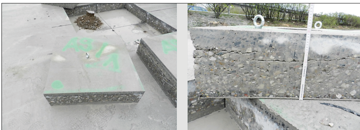
Bild 4-5: BAB A9, Ausbaustück (links) und bereits ausgeprägte Horizontalrissbildung (rechts).
