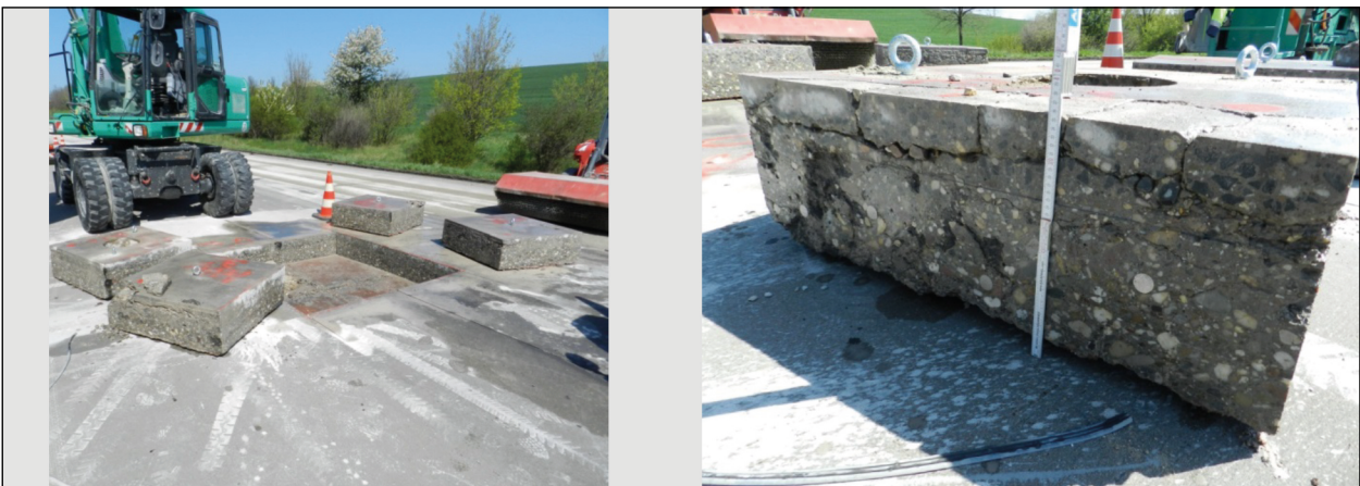
Bild 4-28: BAB A14, Ausbaustücke (links) und Horizontalrissbildung mit Ausbruchstücken (rechts).
