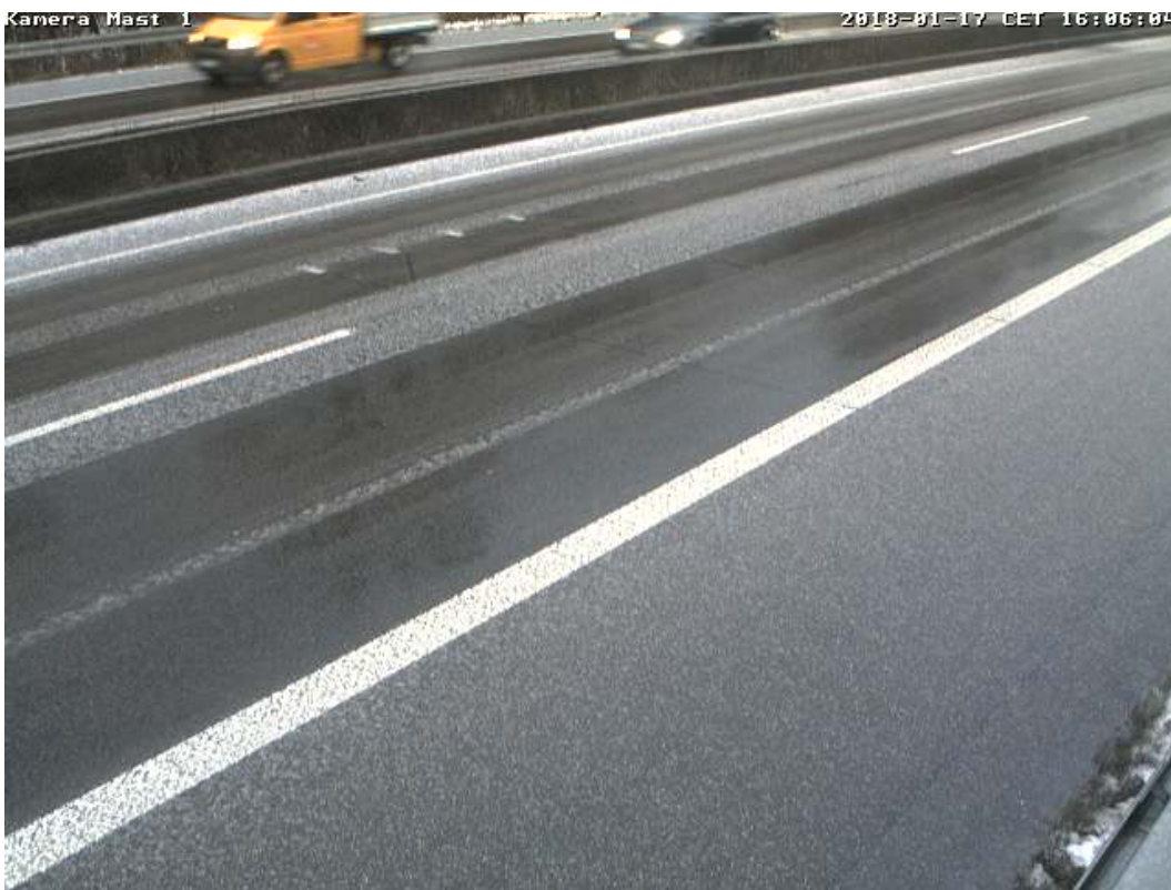
Fahrbahnzustand um 16:06 Uhr
